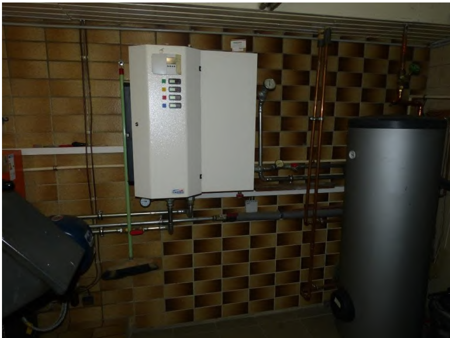
Gebäude 1: Einfamilienhaus, Innenaufnahme Übergabestation Nahwärme im Untergeschoss
