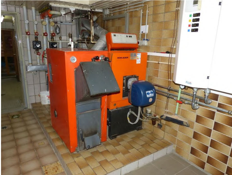
Gebäude 1: Einfamilienhaus, Innenaufnahme Heizkessel im Untergeschoss
