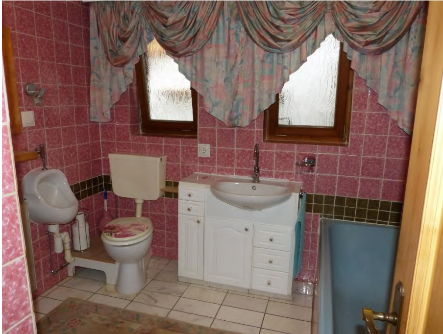
Gebäude 1: Einfamilienhaus, Innenaufnahme Bad im Erdgeschoss
