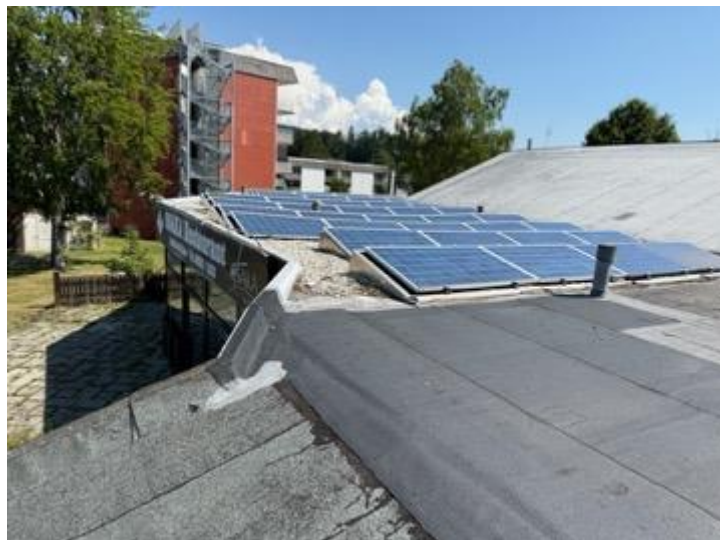
Dach mit fremder PV-Anlage
