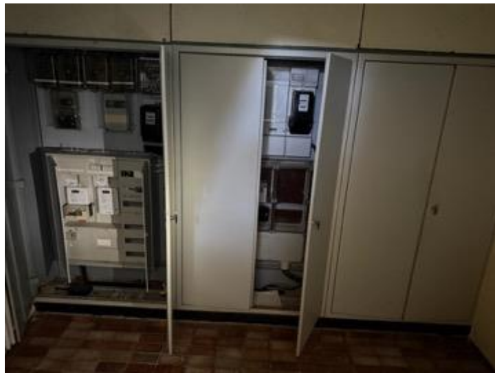
Haustechnik im KG
