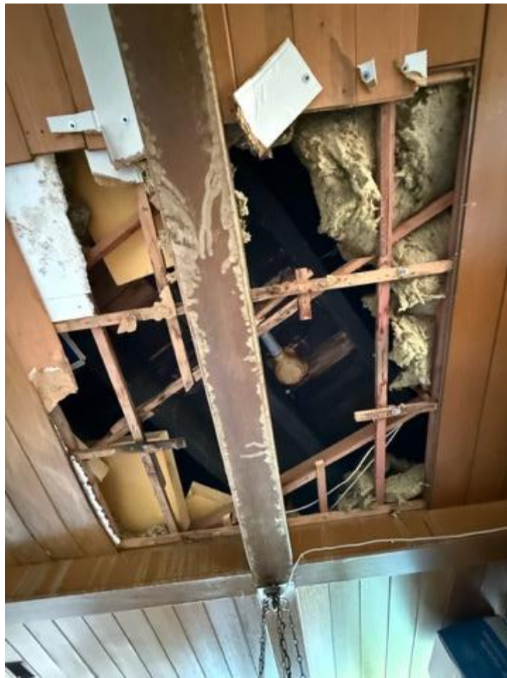
Schadhafte Decke im EG
