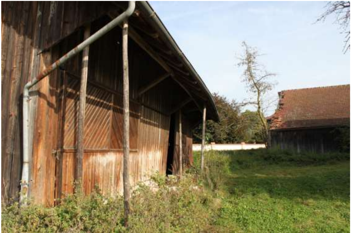
Bild 9: provisorische Abstützung der Überdachung im östlichen Bereich
