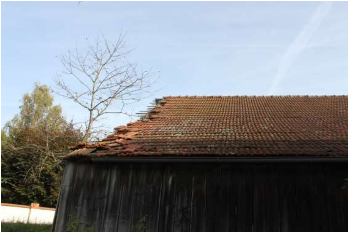
Bild 5: Schaden im nordwestlichen Dachbereich
