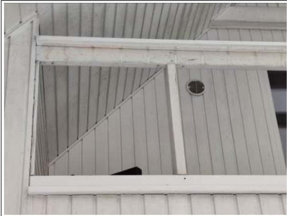
Blick auf das Fehlen von Brettern des Balkongeländers
