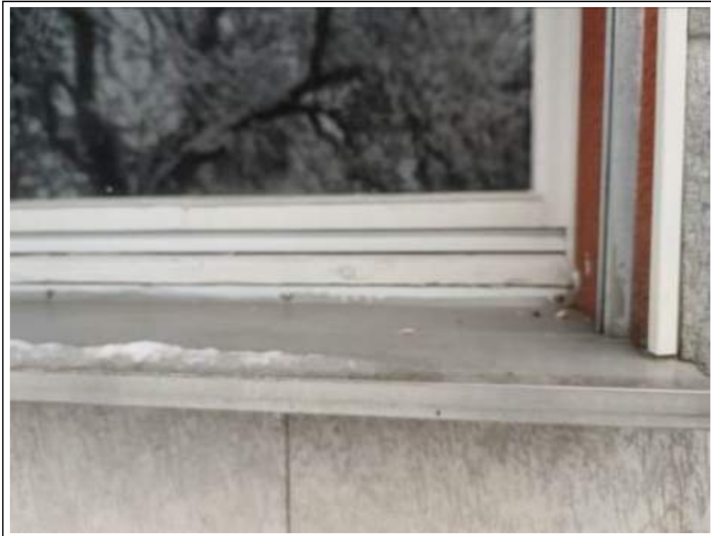
Blick auf eine Fensterbank und den Zustand der alten Holzfenster
