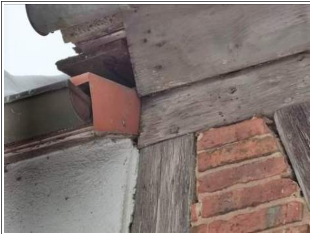
Blick auf das verwitterte Holz der Scheune im Traufenbereich
