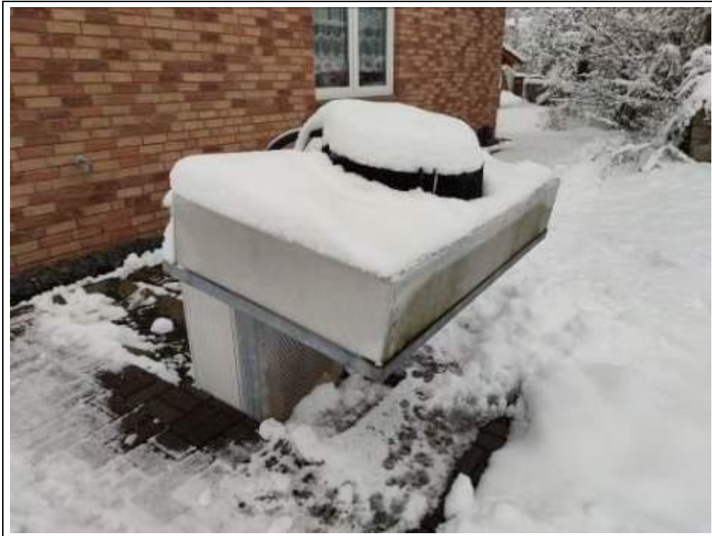
Blick auf die Wärmepumpe als Heizsystem
