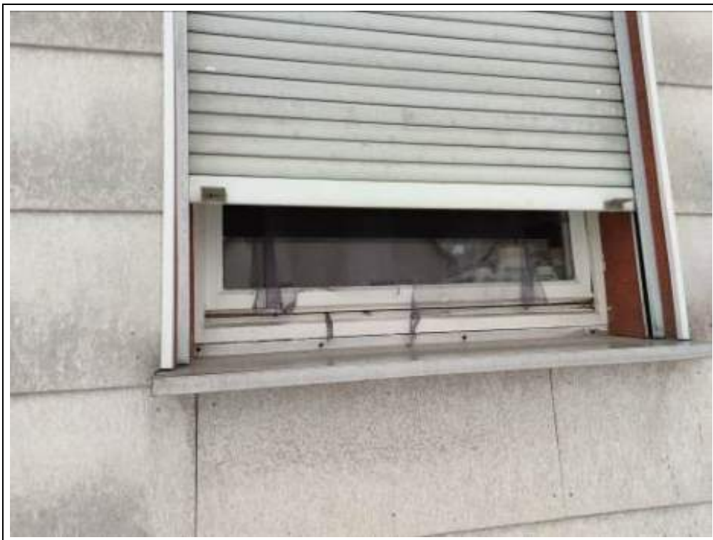
Blick auf den Zustand der Fenster
