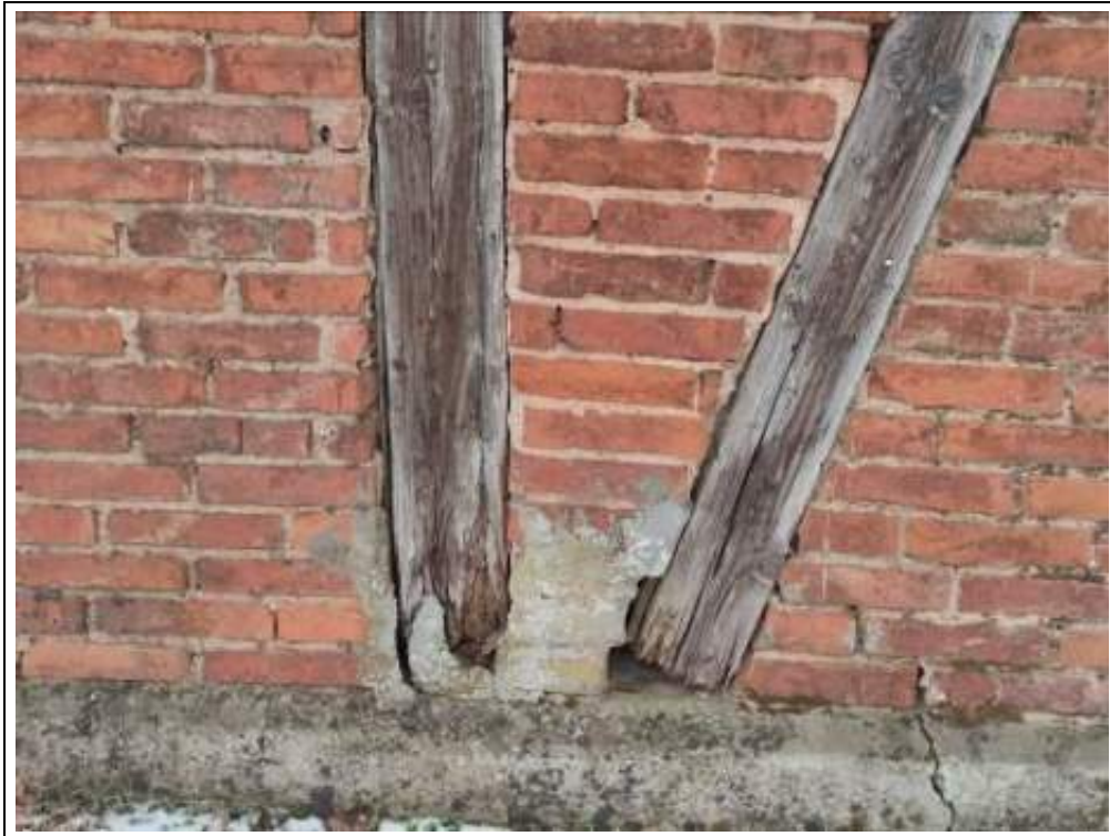
Blick auf Schäden an den Holzbalken
