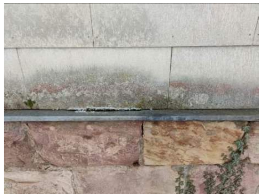
Blick auf Feuchtigkeitsschäden im Sockelbereich der Faserzementverkleidung
