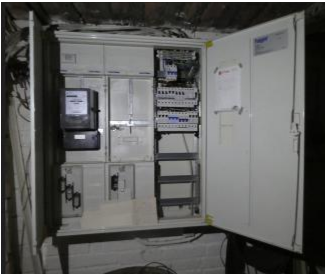
Elektrokasten im Kellerbereich.
