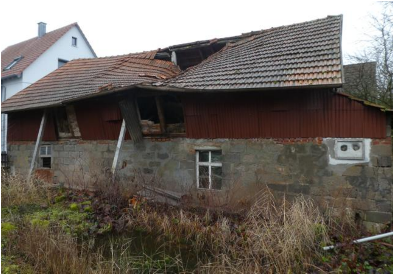
Ehemalige Stallung i Ansicht Nord i im Bild das eingefallene Dach der Stallung.
