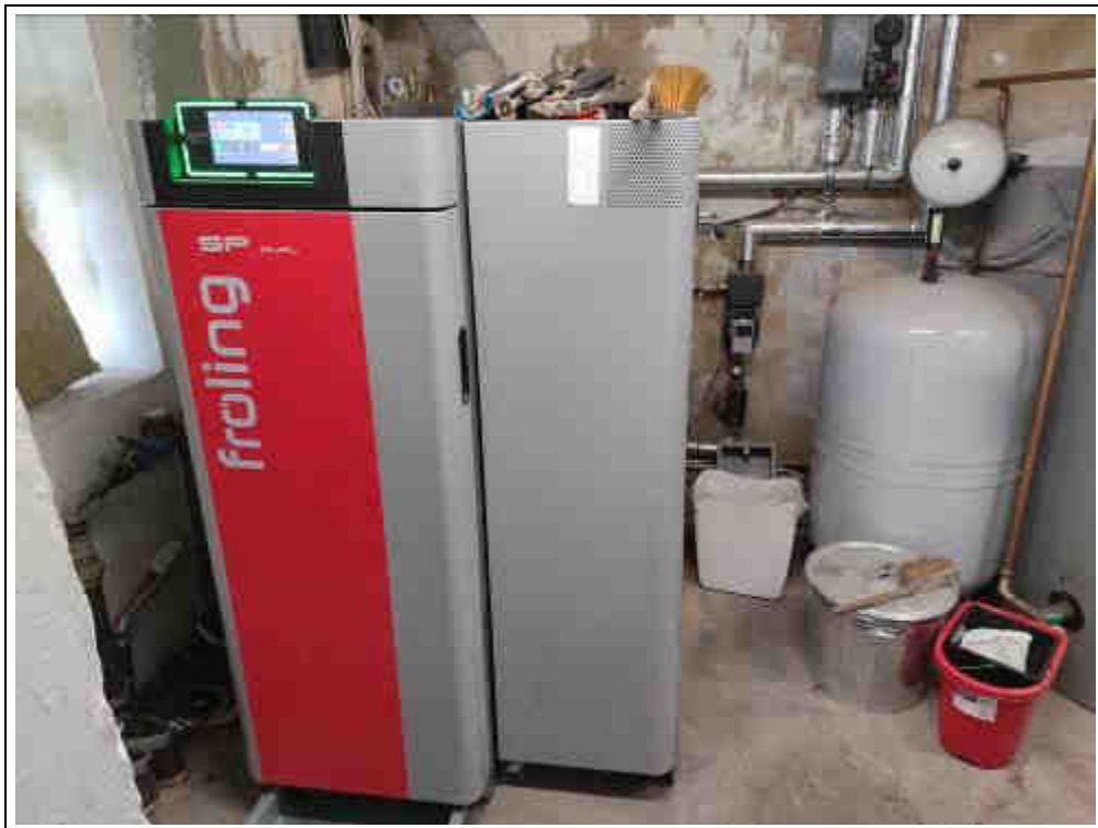
Blick auf die Heizungsanlage
