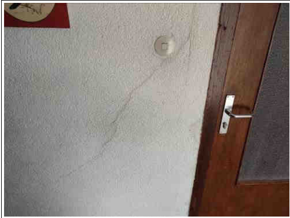
Blick auf einen Riss in einer Wand
