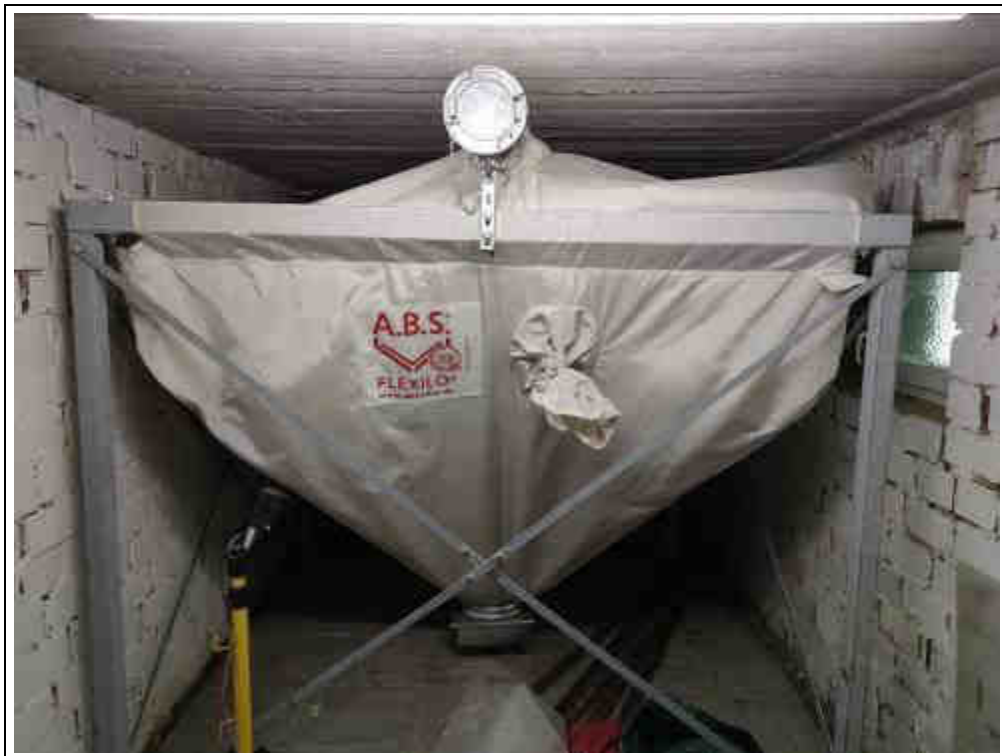
Blick auf das Pelletsilo
