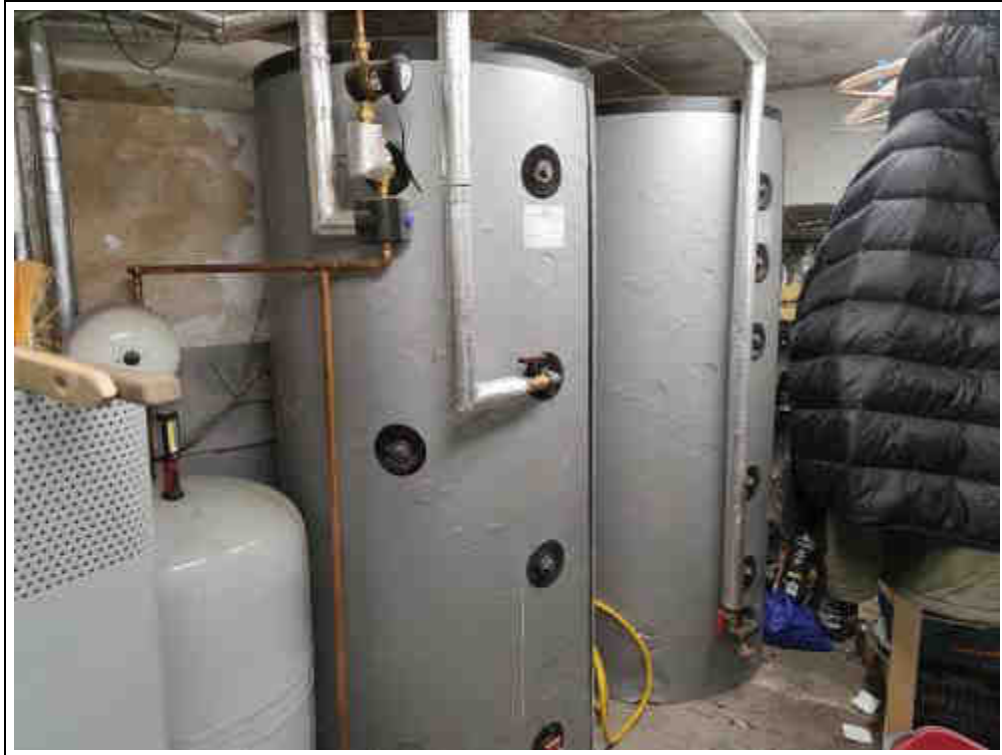
Blick auf die beiden Warmwasserspeicher
