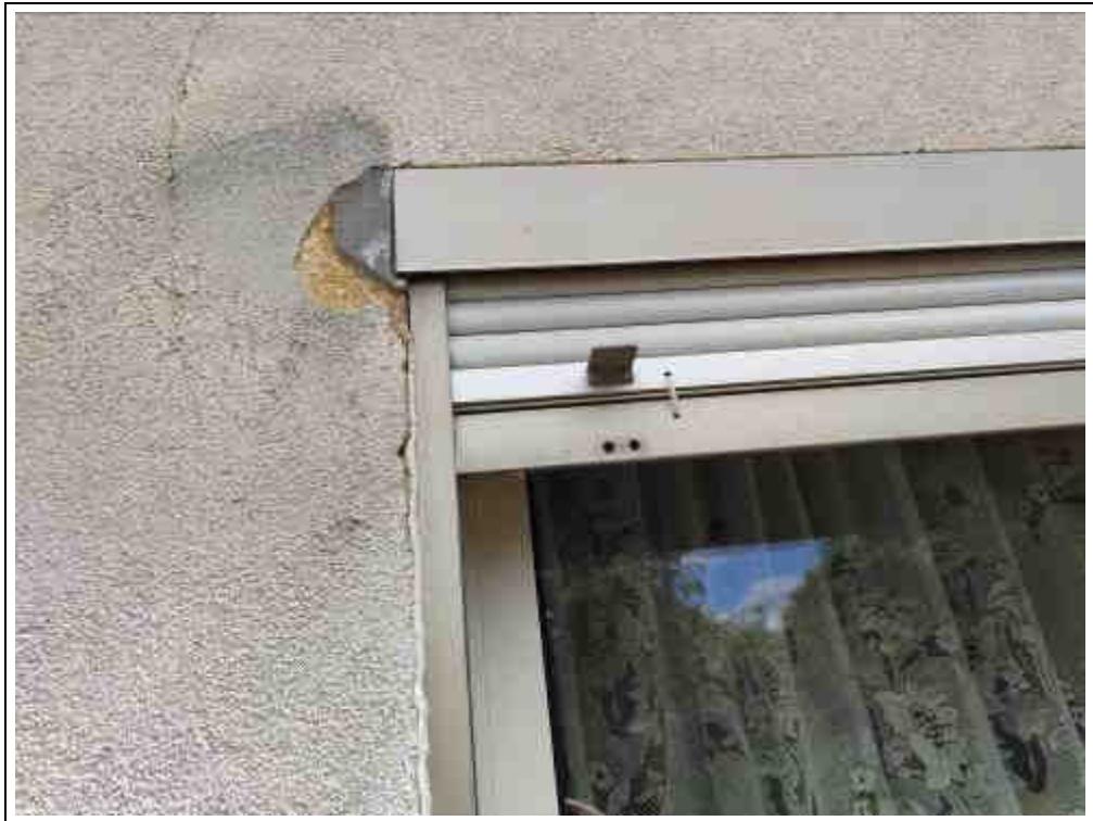
Blick auf einen Riss in der Außenwand
