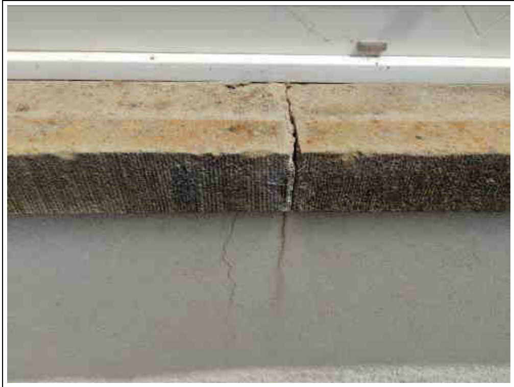
Blick auf einen Riss in der Außenwand und der Fensterbank
