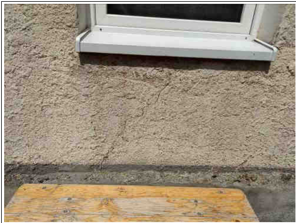
Blick auf einen Riss in der Außenwand
