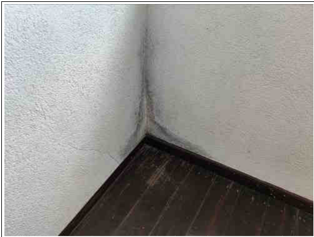
Blick auf einen Feuchtigkeitsschaden im Bereich der Treppe zum Obergeschoss
