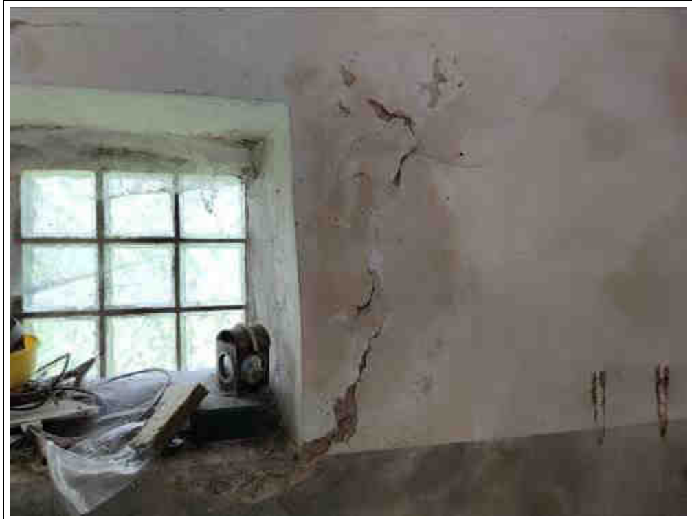
Blick auf einen Riss in der Außenwand der Garage
