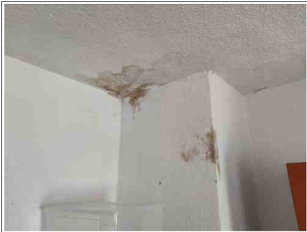
Blick auf einen Feuchtigkeitsschaden im Obergeschoss am Kamin
