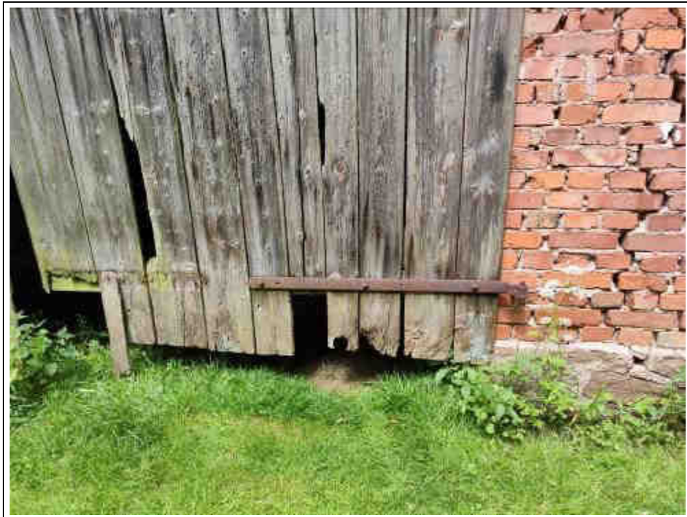
Blick auf Risse in den Außenwänden der Scheune und Zustand des Tores
