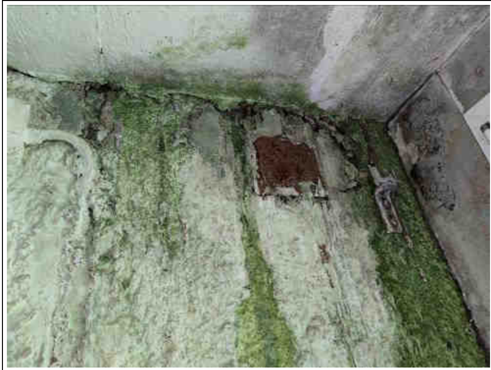
Blick auf einen Feuchtigkeitsschaden im Bereich der Garagendecke
