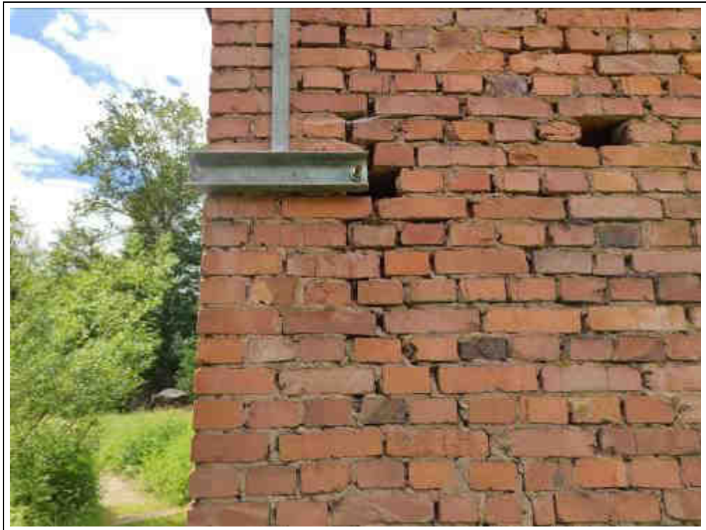
Blick auf Risse in den Außenwänden der Scheune
