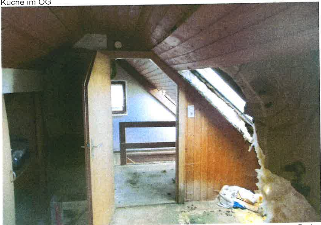
Dachgeschoss mit geschädigter Dämmung (es gibt mehrere Stellen). Auf dem Boden Marderkot.
