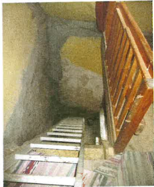
Treppenloch vom EG zum DG mit Leiter.
