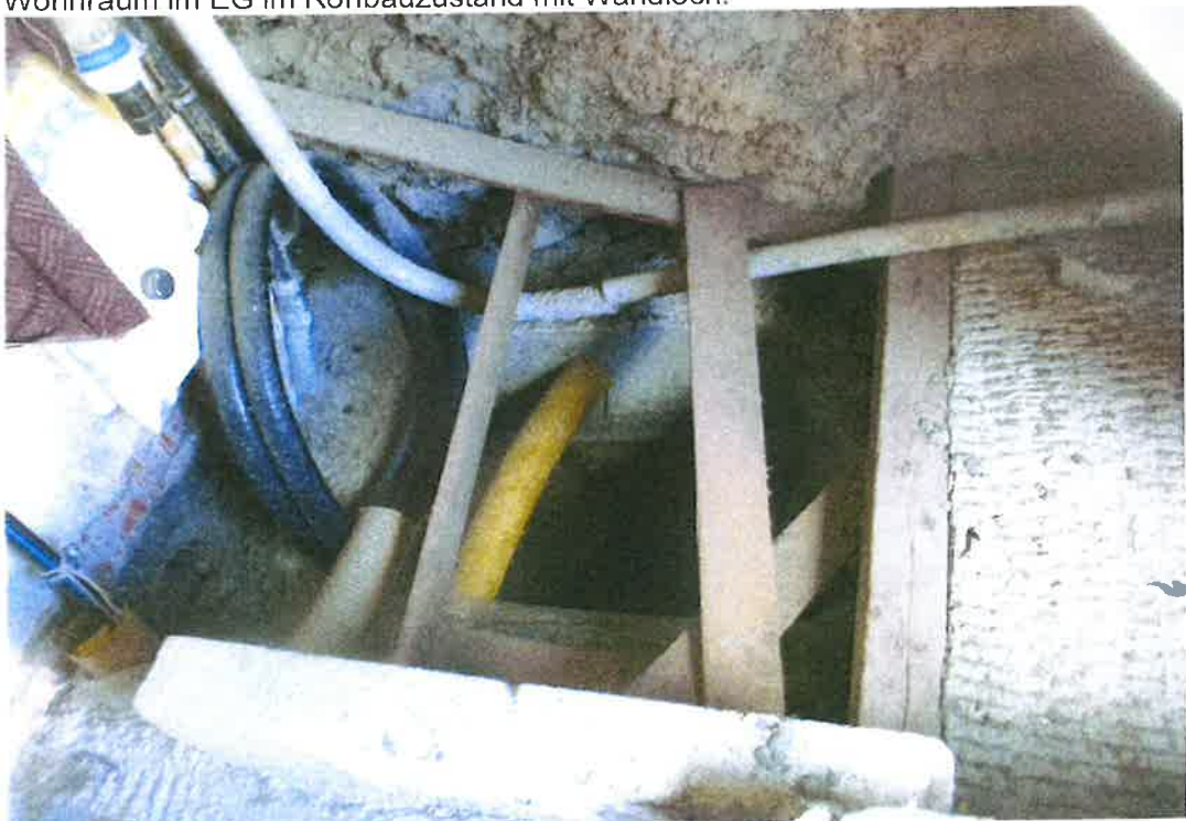
Bodenloch mit Leitungen im EG.
