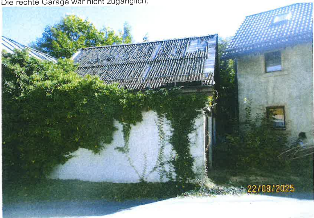
Garage mit schadhafter, undichter Dachdeckung (vgl. Bild oben mit Wasserflecken).
