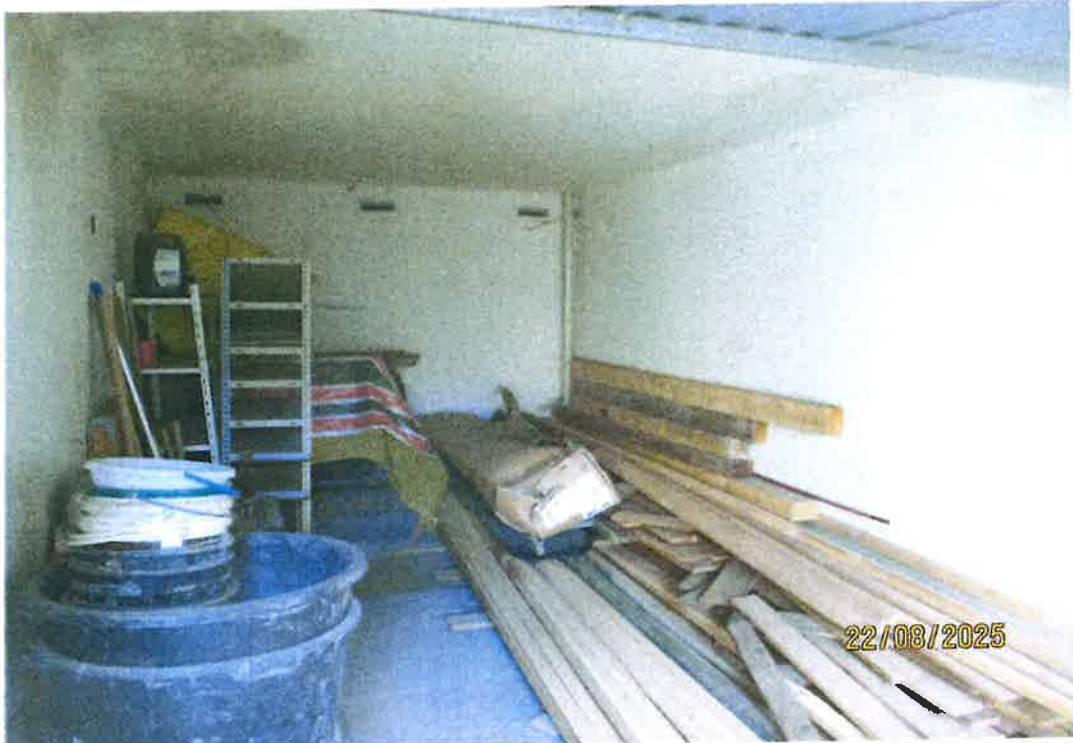
Linke Fertigteilgarage mit Durchfeuchtungsflecken an der Decke (vgl. Bild unten). Die rechte Garage war nicht zugänglich.
