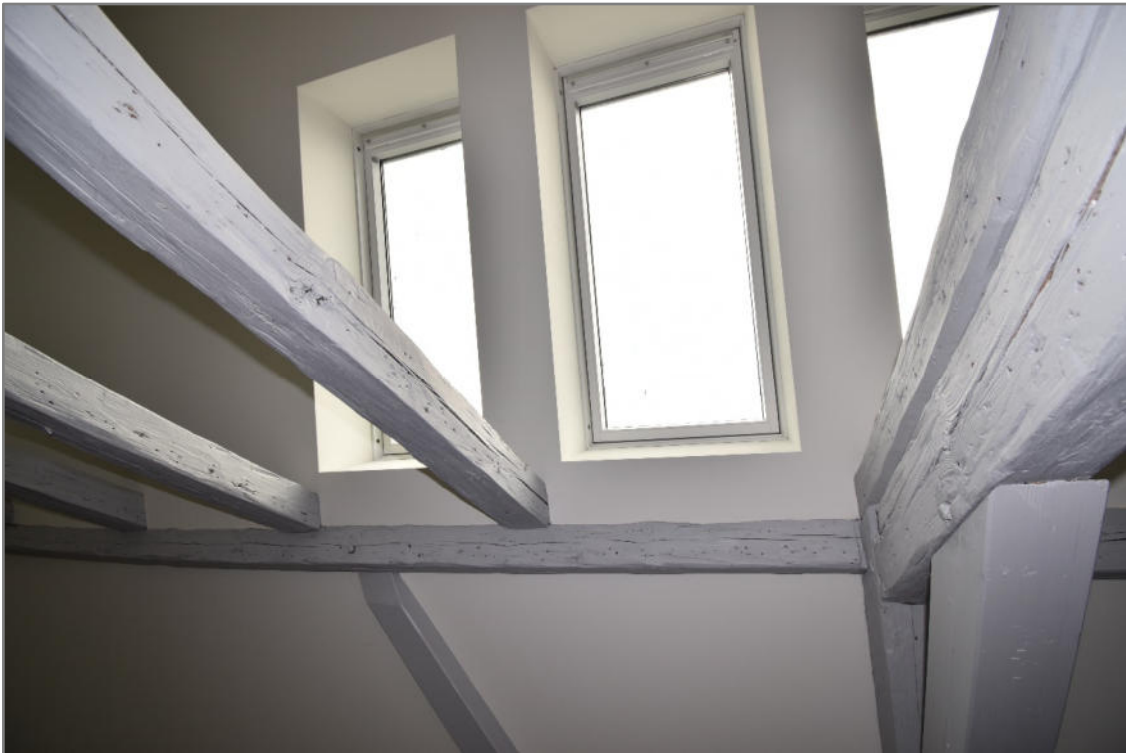
Rathausgasse 4, 2. Obergeschoss, Wohnung Nr. 25, Dachflächenfenster im Archiv
