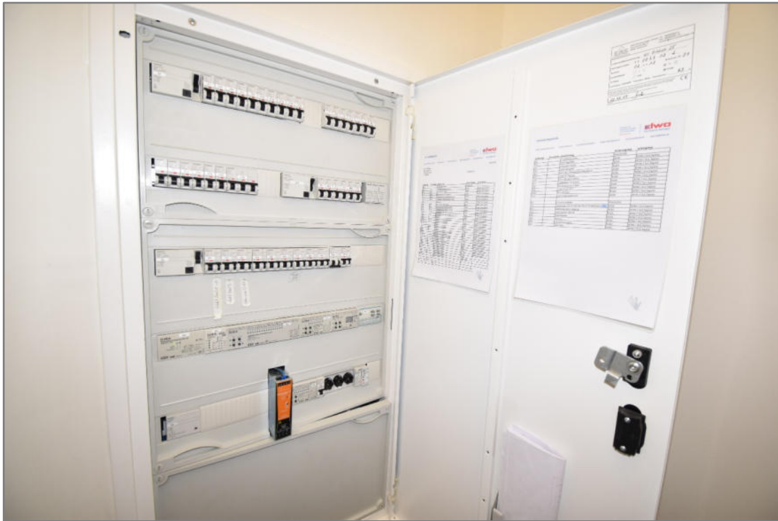
Rathausgasse 4, 2. Obergeschoss, Wohnung Nr. 25, Sicherungskasten
