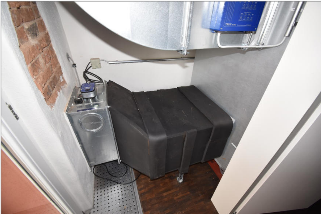
Rathausgasse 4, 1. Obergeschoss, Wohnung Nr. 15, Blick auf die Belüftungsanlage
