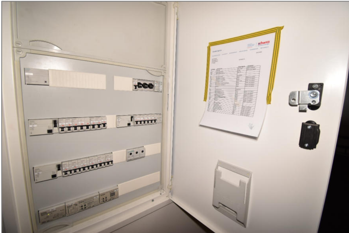
Rathausgasse 4, 1. Obergeschoss, Wohnung Nr. 15, Sicherungskasten
