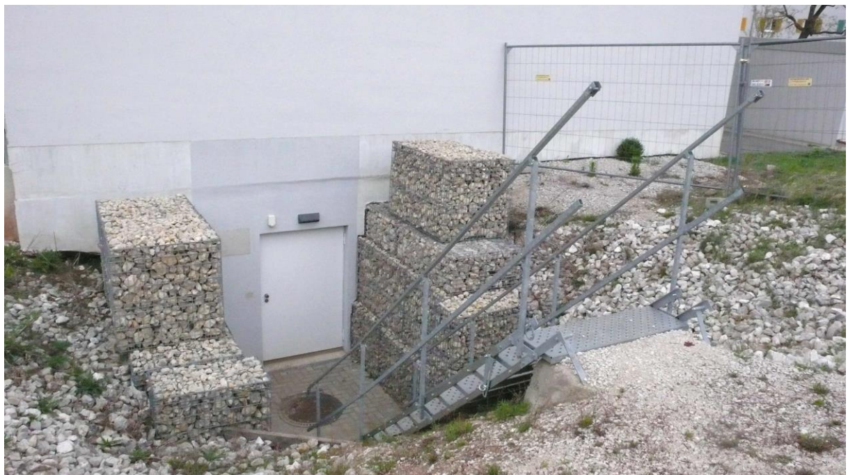
Abbildung 9 Bewertungsgegenstand IV - Baufläche - Flurstück Nr. 316/15 - Grundstücksgrenze Nord Abgrabung zum Nachbargebäude Hsnr. 33 / dinglich gesichertes Fluchtwegerecht
