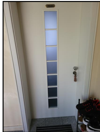
Beispiel für Innenansicht und Objektzustand: Eingangstüre zur Wohnung SOE Nr. 2 im OG
