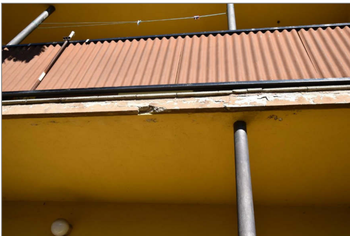
Schalkhaußerstraße 82, schadhafte Bodenplatte des Balkons der Wohnung im Obergeschoss
