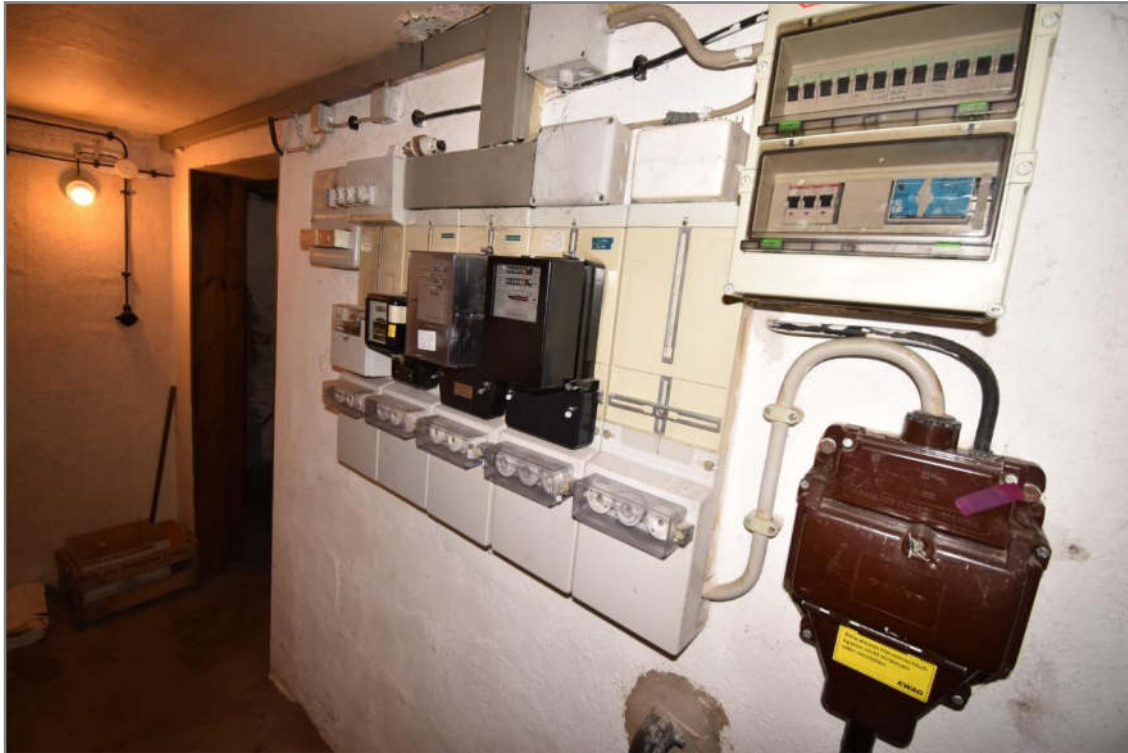
Kellergeschoss, Kellerflur mit Stromzählern und Sicherungen
