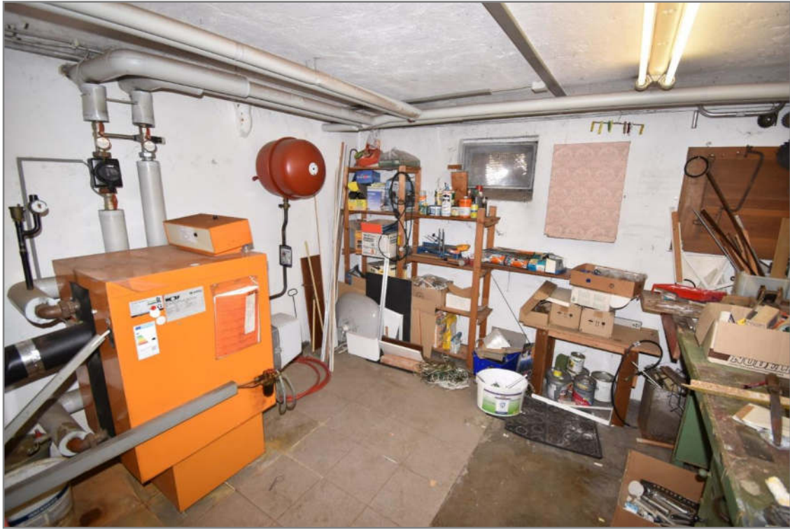
Wohnhaus, Kellergeschoss, Heizungsraum
