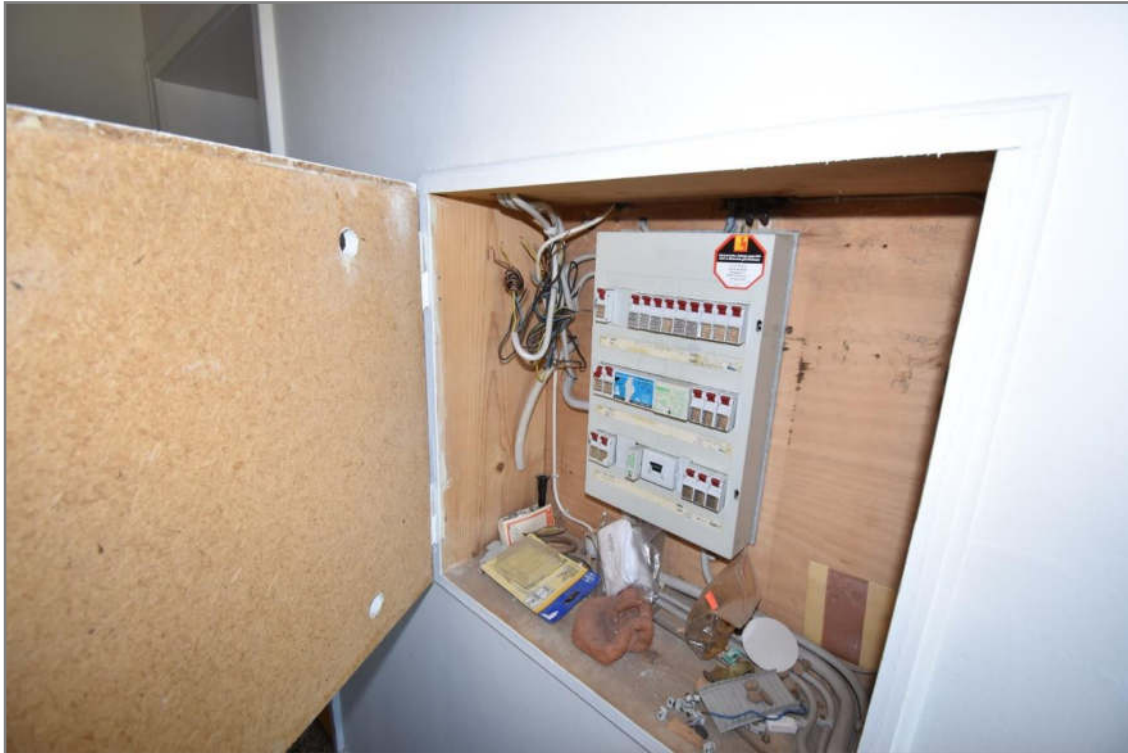
Wohnhaus, Obergeschoss, Sicherungskasten am Treppenpodest
