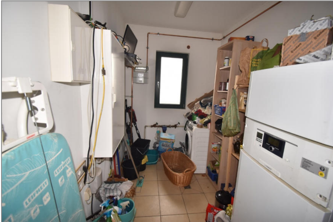
Wohnhaus Erdgeschoss, Hausanschlussraum mit Heizungsanlage
