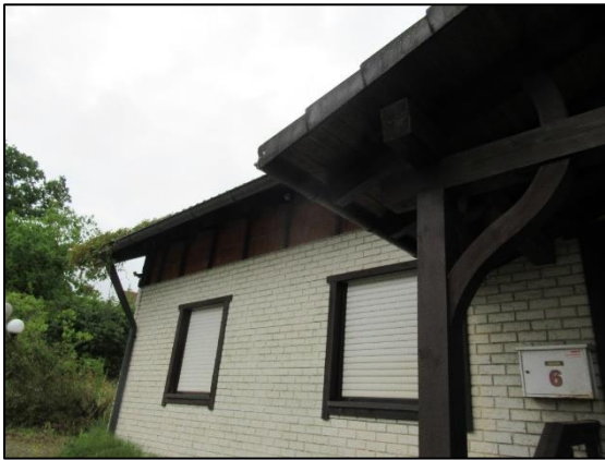
Fassade – Verblendung fehlt
