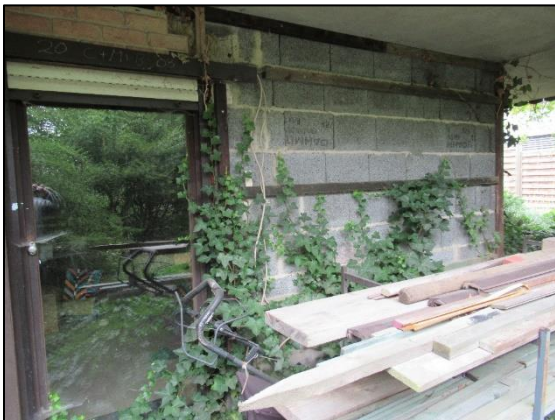
Fassade – Verblendung fehlt
