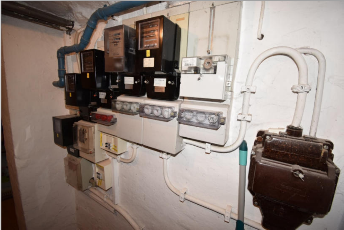
Ebenseestraße 9, Kellergeschoss, Hausanschluss-/Waschmaschinenraum, Stromzähler
