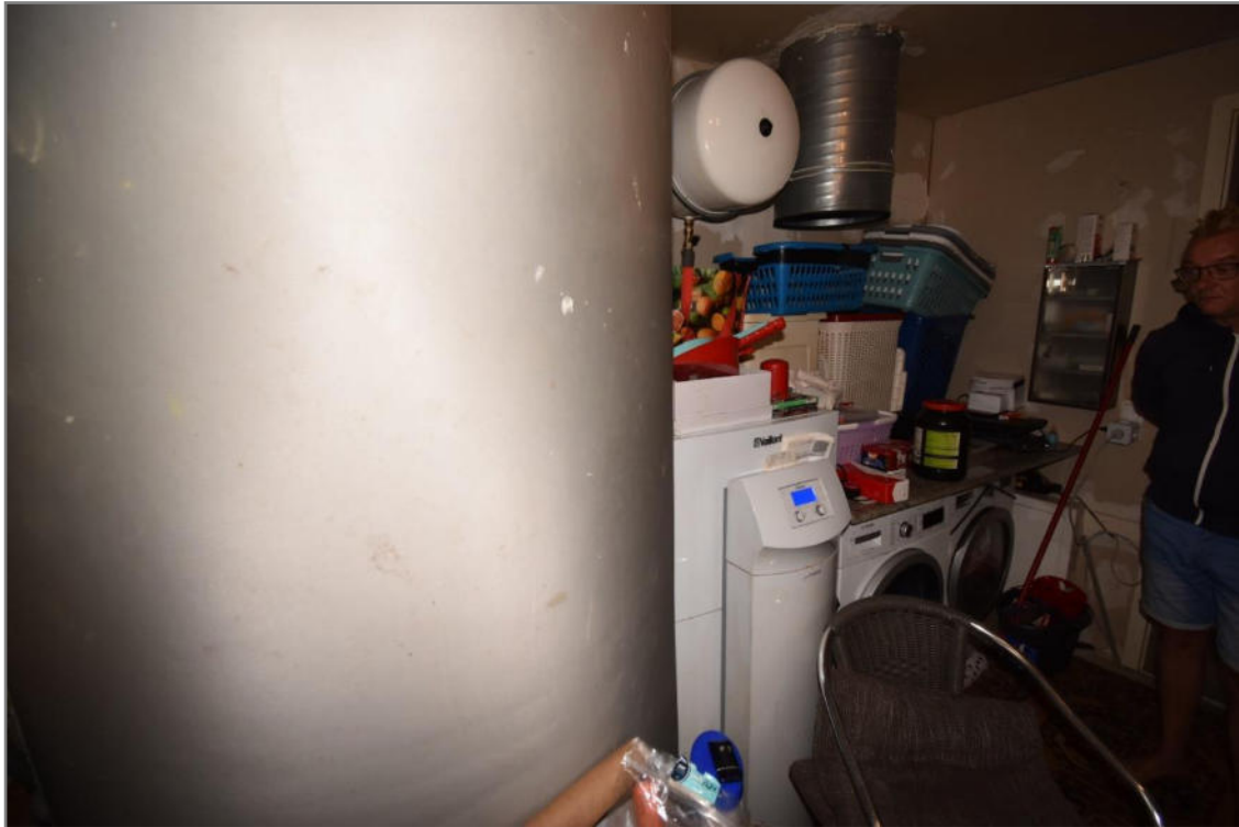
Weierweg 11, Hauptwohnung, EG, Heizungs-/Hauswirtschaftsraum im Norden
