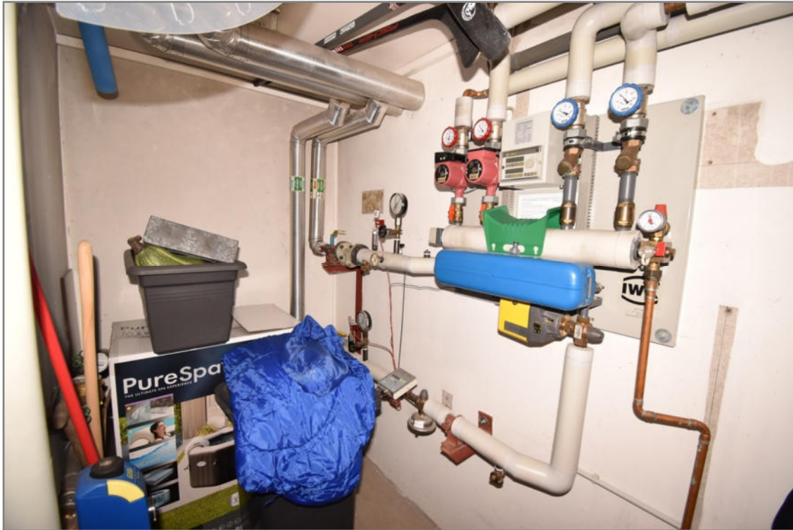
Hans-Fallada-Straße 197, Kellergeschoss, Hausanschlussraum mit Übergabestation
