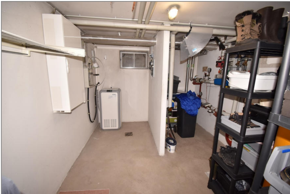
Hans-Fallada-Straße 197, Kellergeschoss, Hausanschlussraum mit Batteriespeicher (links) und Übergabestation (rechts)
