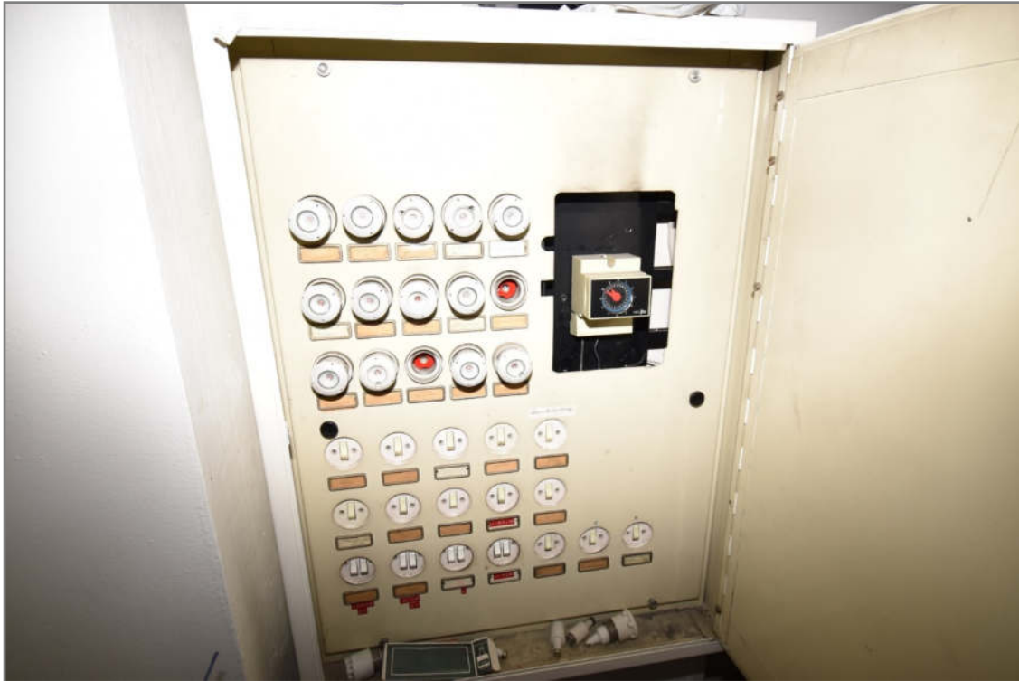
Gewerbeeinheit Nr. 14, Sicherungskasten
