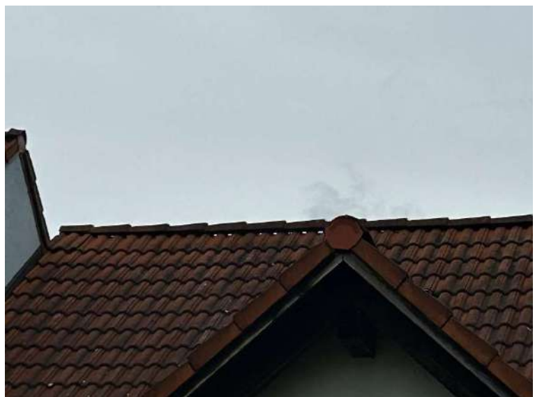
Mangelhaft verlegtes Dachfirstziegel
