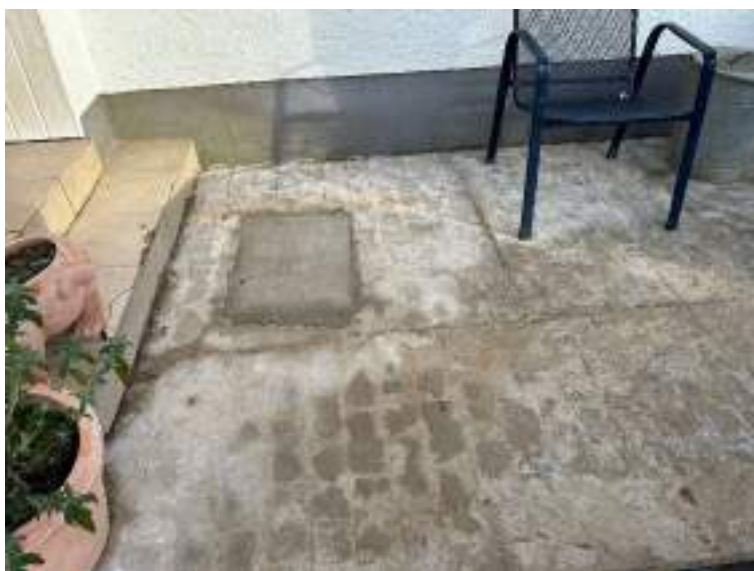
Fehlender Fliesenbelag Eingangsbereich
