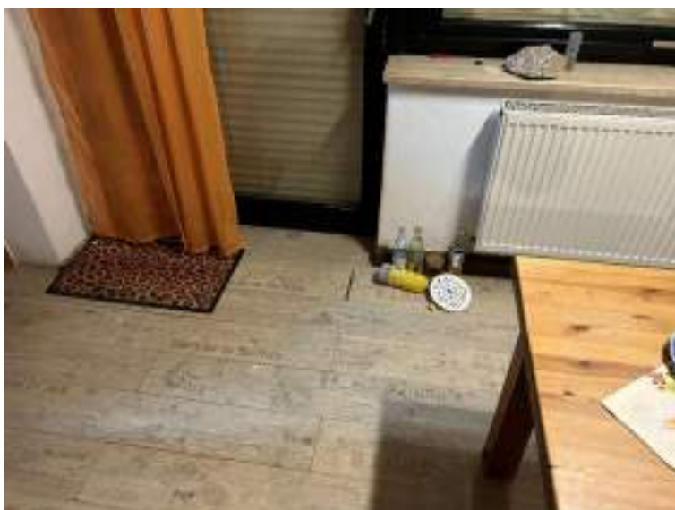
Unfachmännisch verlegter Bodenbelag
