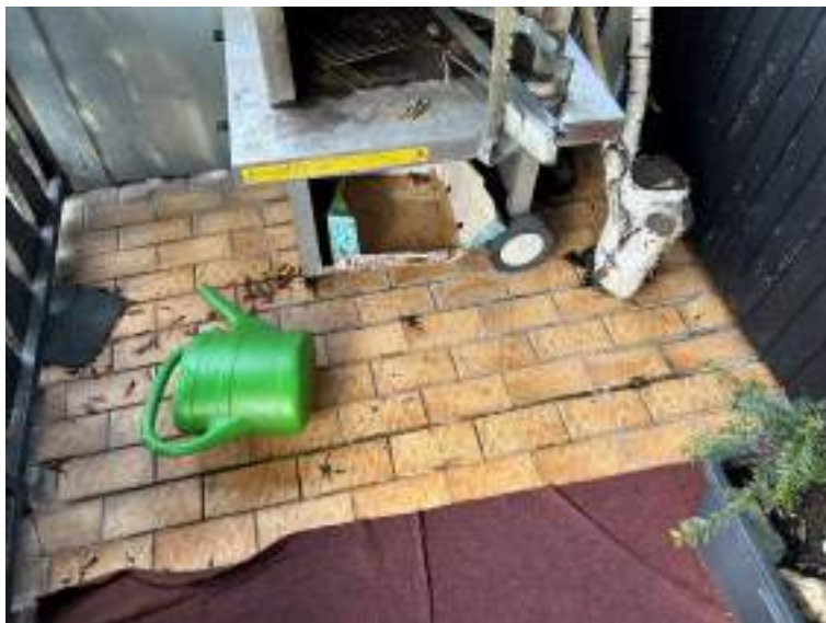
Gerissene/Lose Fliesen Balkon
