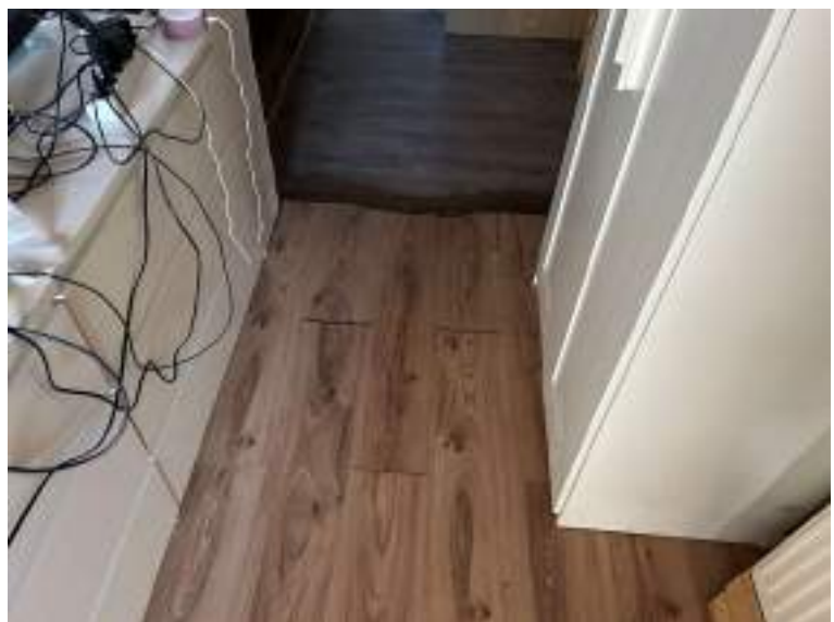
Unfachmännisch verlegter Bodenbelag
