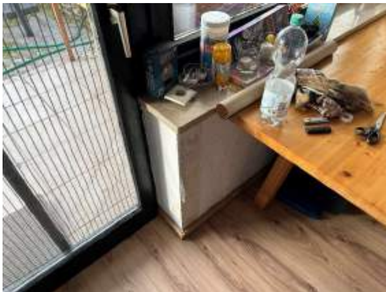
Beschädigte Tapete Kinderzimmer EG
