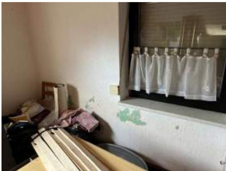
Beschädigte Tapete Kinderzimmer OG
