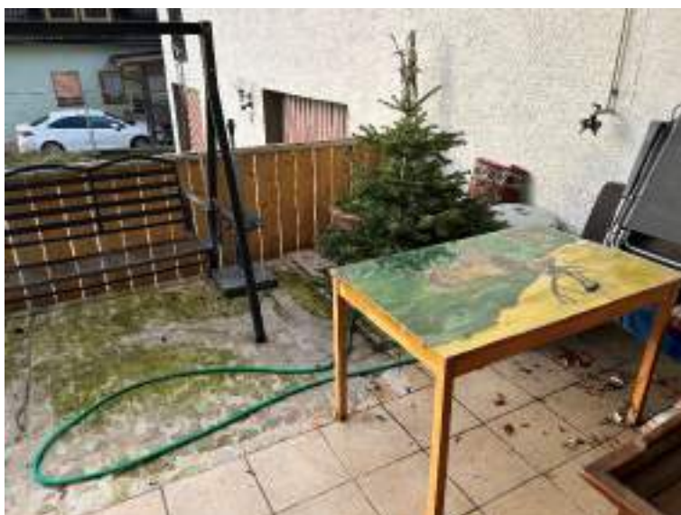
Gerissener Estrich, fehlender Fliesenbelag Terrasse
