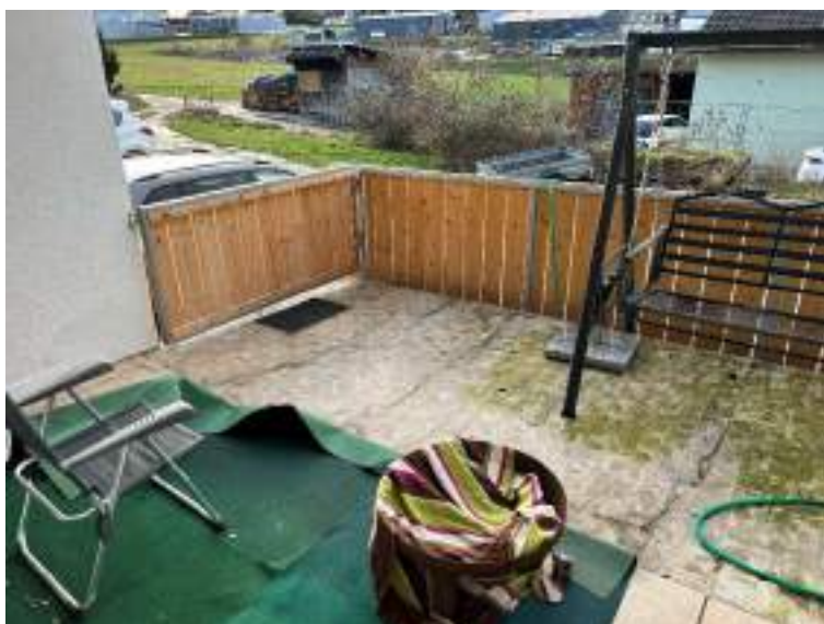
Gerissener Estrich, fehlender Fliesenbelag Terrasse
