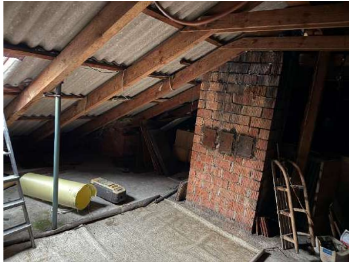
Ungedämmte oberste Geschossdecke
