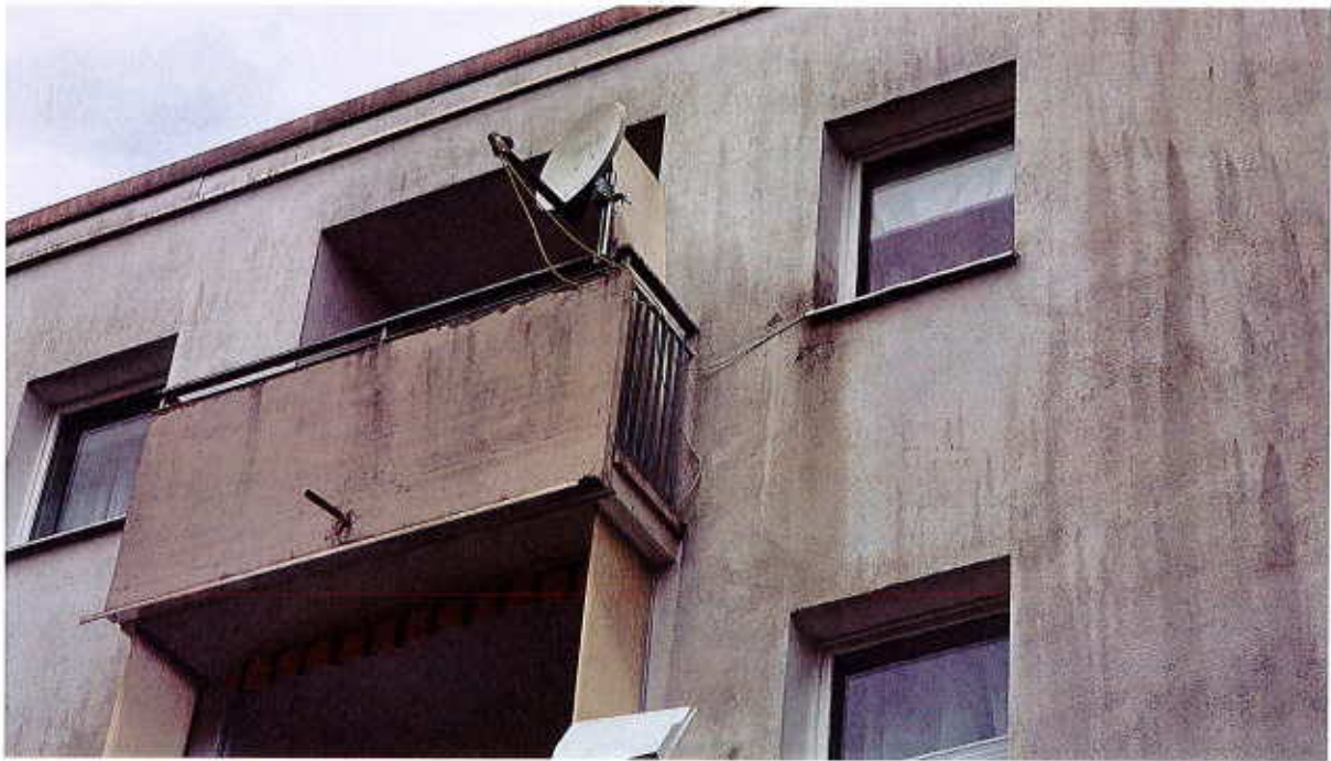
Ausschnitt Schadensbild Fassade
