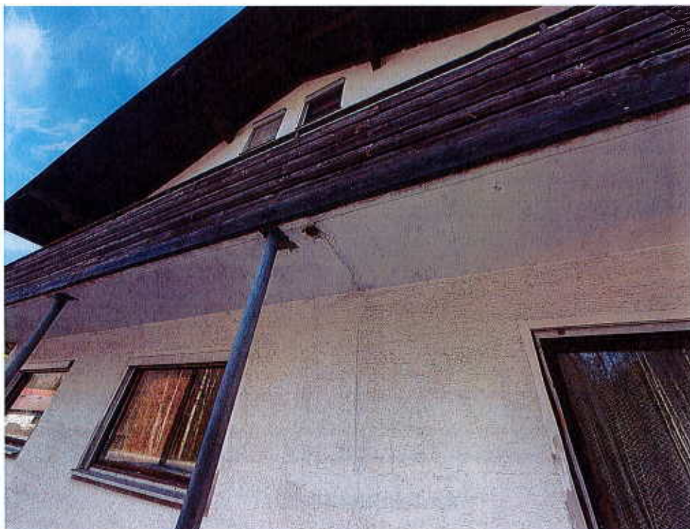
Schaden am Balkon
