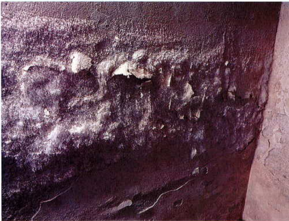
Beispiel für Schaden im Keller
