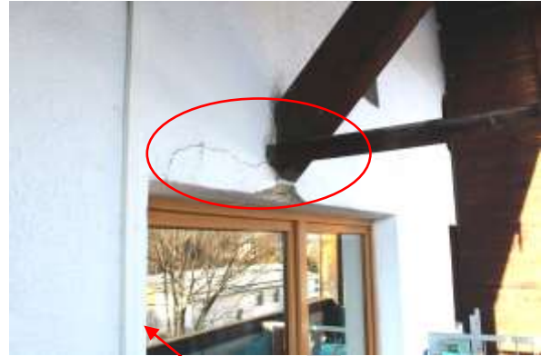
Abb. 21: Fassadenschäden im Bereich der Whg. Nr. 5, Kabelkanal
