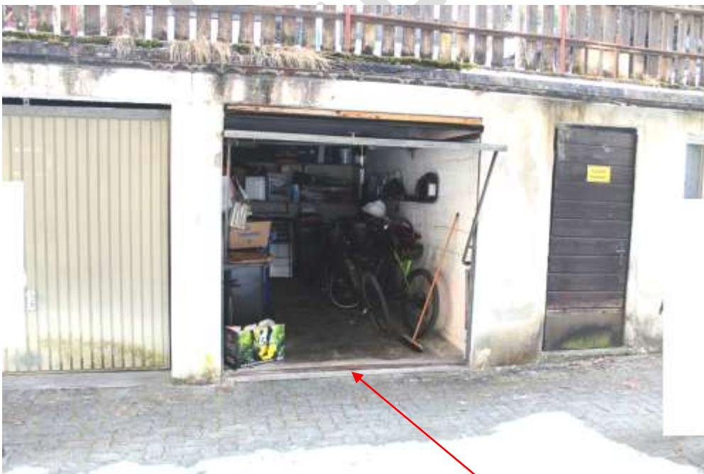
Abb.10a: Sanierungsbedürftiger Garagentrakt, Garage Nr. 5 von innen
