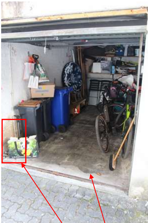
Abb. 10b: Feuchtigkeit, Bodenschäden
