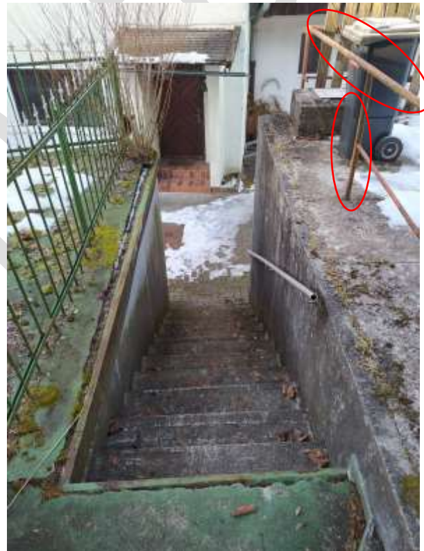
Abb. 22: Treppe vom Garten in den Hof (Nachbargrundstück), rostiges Geländer (beispielhaft)
