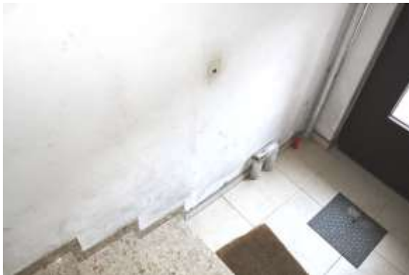
Abb. 12b: Treppenhaus, Feuchtigkeit
