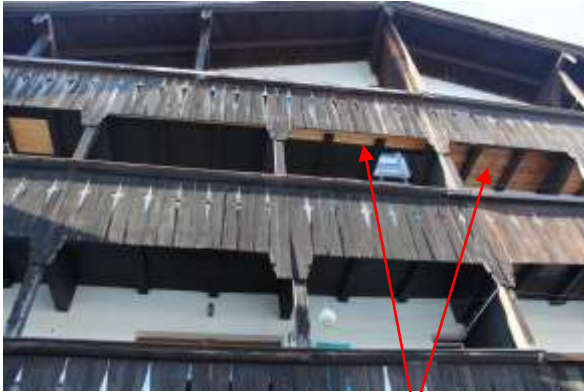
Abb. 19e: Balkonuntersicht, erneuerte Balkonbodenbretter, anstrichbedürftige Holzteile
