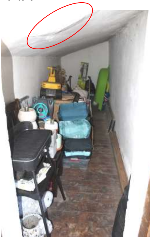
Abb. 20: Balkonabstellraum, Decke mit Putzschäden
