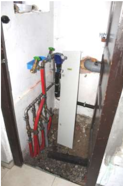
Abb. 13: Hausanschlussraum (ehem. WC)
