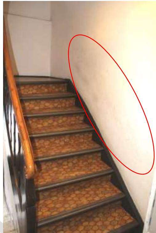
Abb. 14: Treppenhaus, Wand anstrichbedürftig (beispielhaft)
