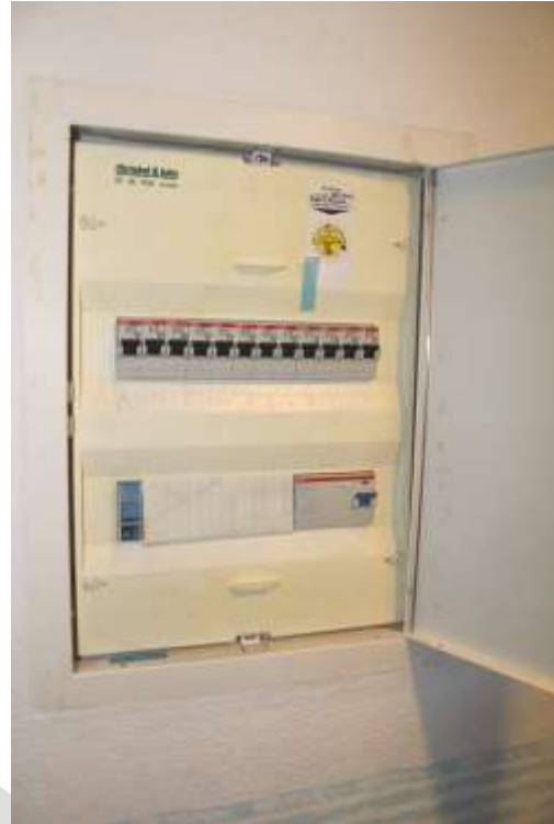
Abb. 18: Sicherungskasten von Whg. Nr. 5
