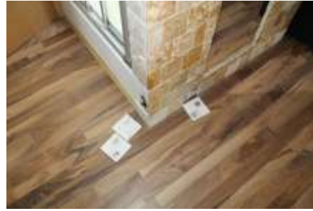
Abb. 38b: Natursteinverkleidung locker
