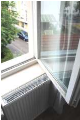
Abb. 38: Holzfenster im DG – Zustand
