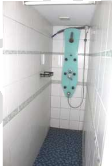
Abb. 46: KG – Dusche defekt
