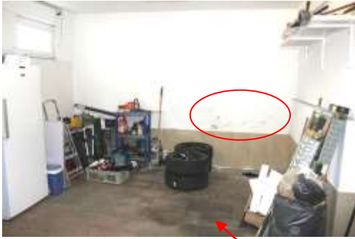
Abb. 52a: Garage innen – Feuchtigkeitsschäden; Boden fleckig
