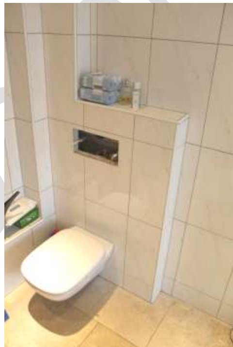
Abb. 29c: WC – lt. Aussage defekt
