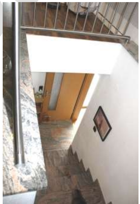
Abb. 36: Unfachmännisch mit Silikon befestigtes Treppengeländer DG - Blick ins OG
