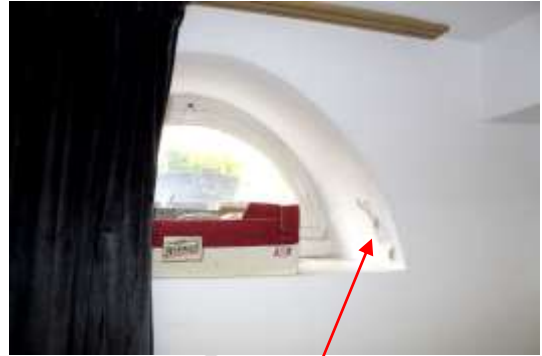
Abb. 45: KG – Putz- und Farbschäden durch Feuchtigkeit im Fensterbereich
