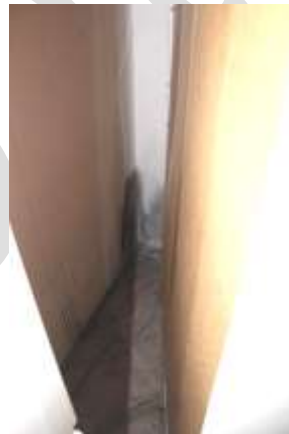
Abb. 10a: Schimmel – Windfang (Außenecke) Treppenhaus innen (hinter Schrank)
