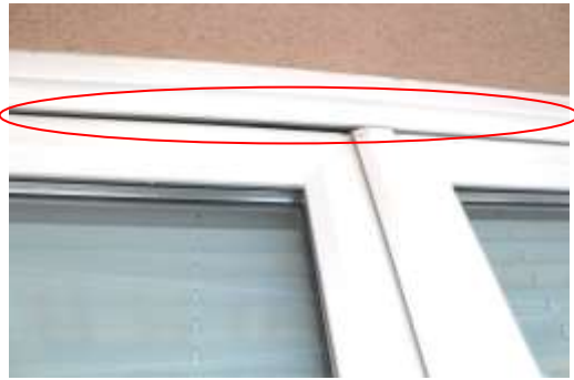
Abb. 33: Wohnzimmerfenster (Süd) schließt nicht
