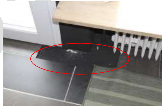
Abb. 12c: Ladentür - fehlende Boden- fliesen
