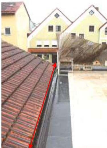
Abb. 27a: Fehlende Absturzsicherung an Ostseite zum Garagendach des Nachbarn
