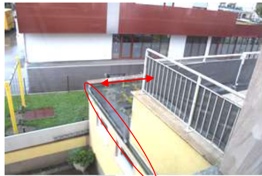
Abb. 28: Dach Zufahrt - fehlende Absturzsicherungen
