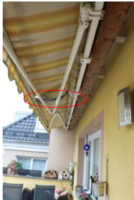
Abb. 32a: Markisenstoff erneuerungsbedürftig (beispielhaft)
