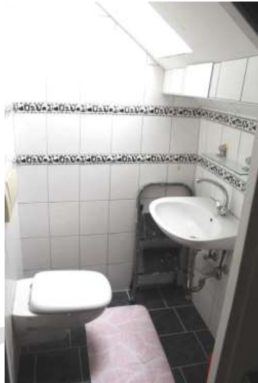
Abb. 40a: WC defekt; Tür fehlt
