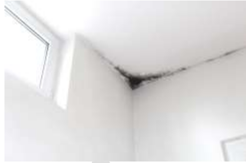
Abb. 52d: Garagendecke Schimmel
