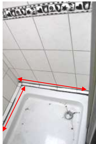
Abb. 38d: Dusche – Fugen erneuerungsbedürftig
