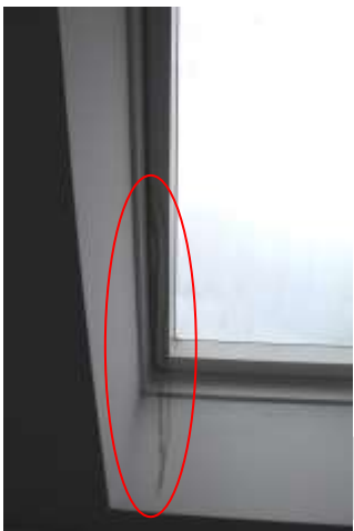
Abb. 39: Wasserspuren am Dachflächenfenster
