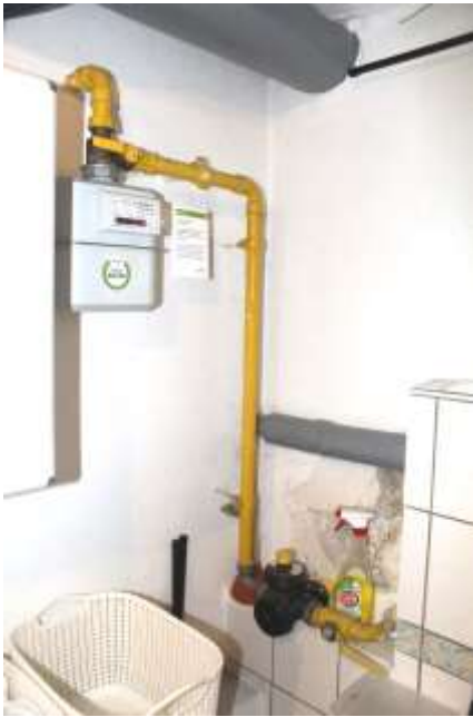
Abb. 48: KG - Gasanschluss, Feuchtigkeitsschäden, beispielhaft
