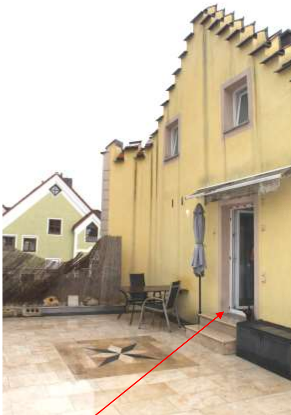
Abb. 27: Garagendach – Zugang über Küchentür, Zustand Fassade (beispielhaft)
