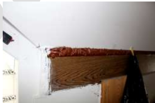
Abb. 40b: Einschäumung sichtbar
