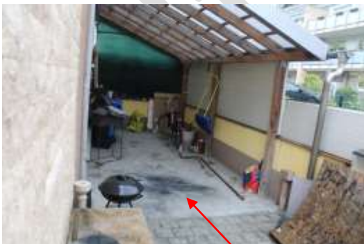
Abb. 9: Überdachter Abstellbereich neben Hauseingang, Boden fleckig
