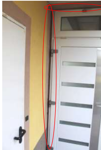
Abb. 6a: Hoftür – Türeinschäumung sichtbar (beispielhaft)
