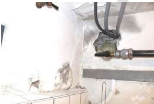
Abb. 49: KG- Offene Reparaturstellen ehem. Wasserschaden
