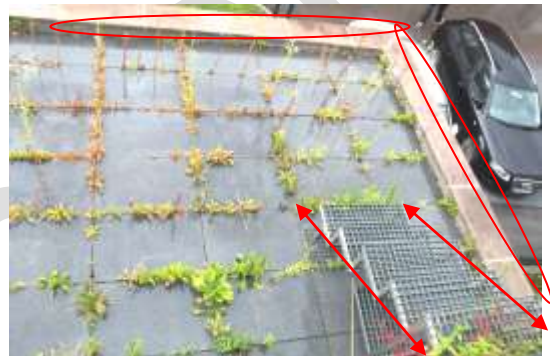
Abb. 28a: Dachzugang mit Treppe zum nördl. Garagendach - fehlende Absturzsicherungen, Bewuchs
