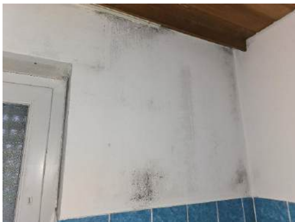
Wohnung EG/ Bad/ Schimmelflecken
