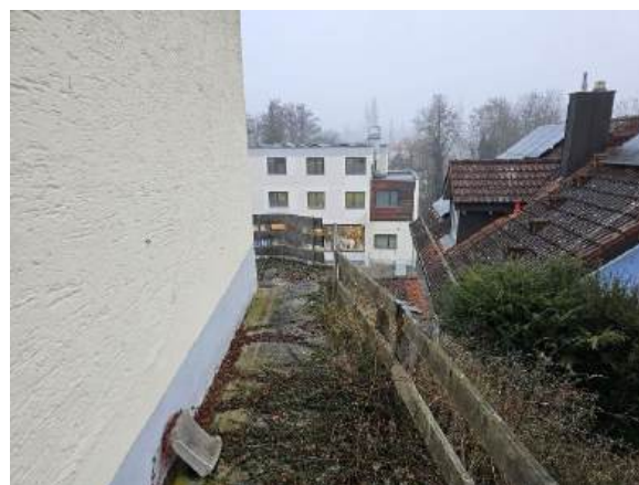
Wegbefestigung seitlich vom Haus/ Flst. 359/45
