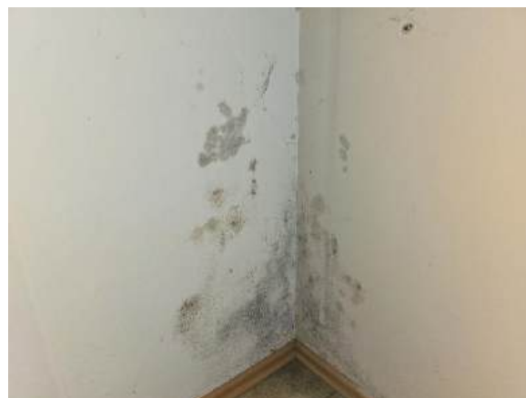
Wohnung EG/ Küche/ Schimmelflecken
