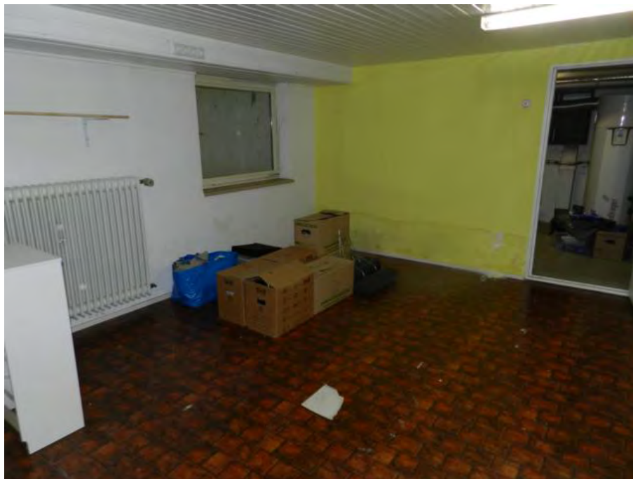
Kellerraum; Feuchteschaden an Wand
