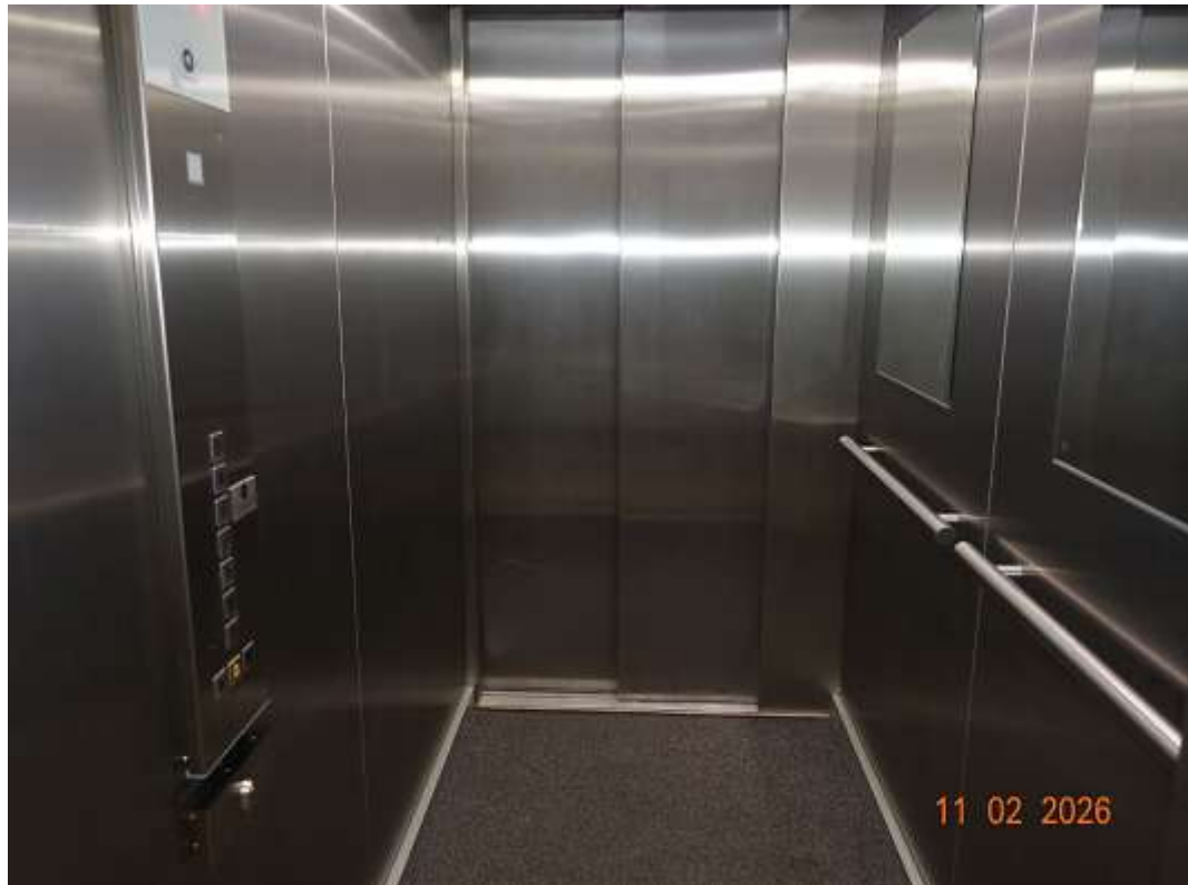
Abbildung 3: Moderner Personenaufzug im Wohn- und Geschäftshaus bis in die Tiefgarage
