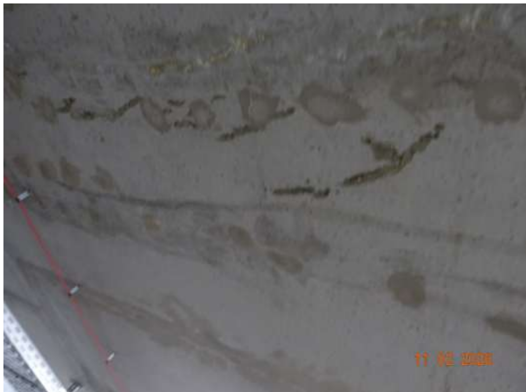
Abbildung 12: Schadhafte Betondecke in der Tiefgarage, teilsaniert
