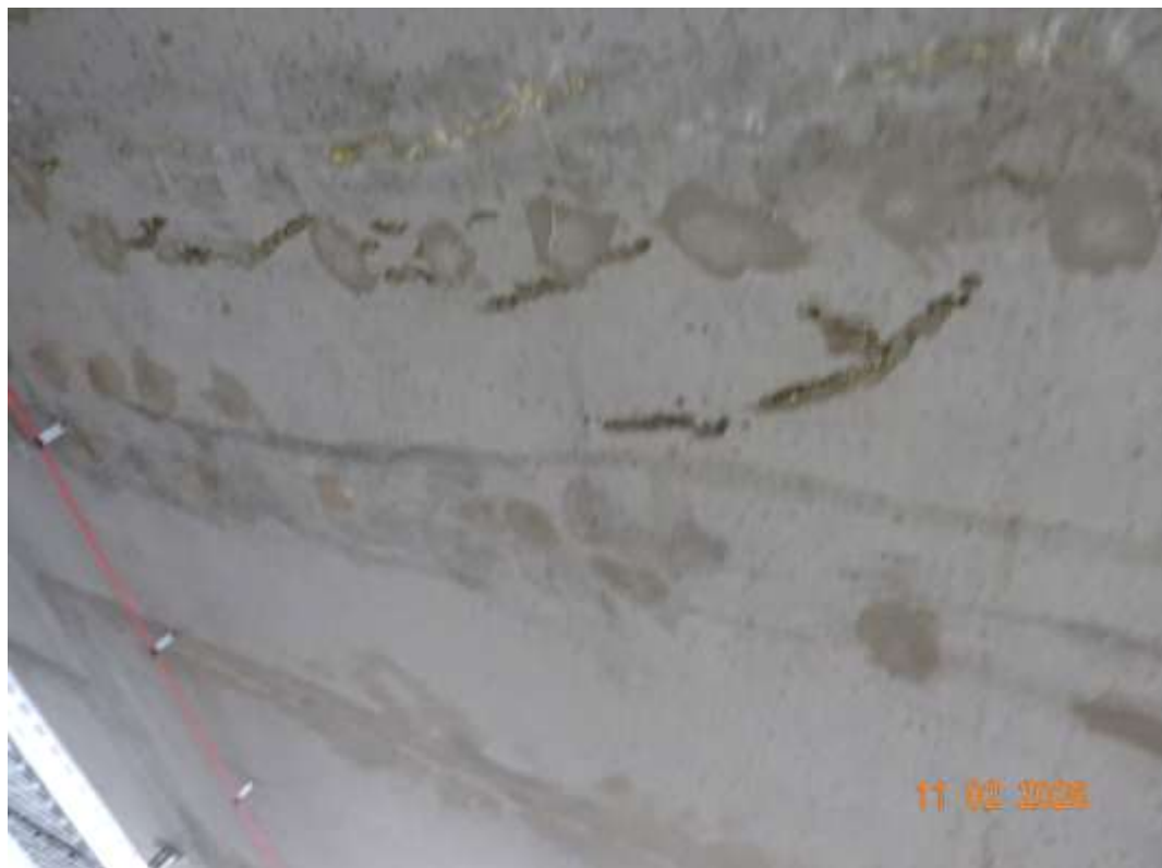
Abbildung 6: Schadhafte Betondecke in der Tiefgarage, teilsaniert
