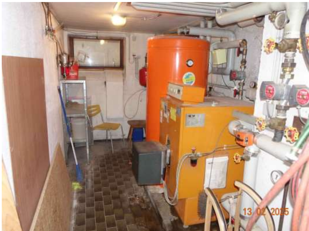
Abbildung 40: Heizungsraum im Wohnhaus
