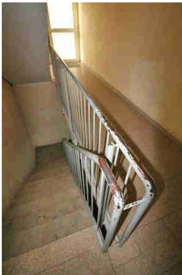
Blick auf Treppenge- länder (Neuanstrich erforderlich)
