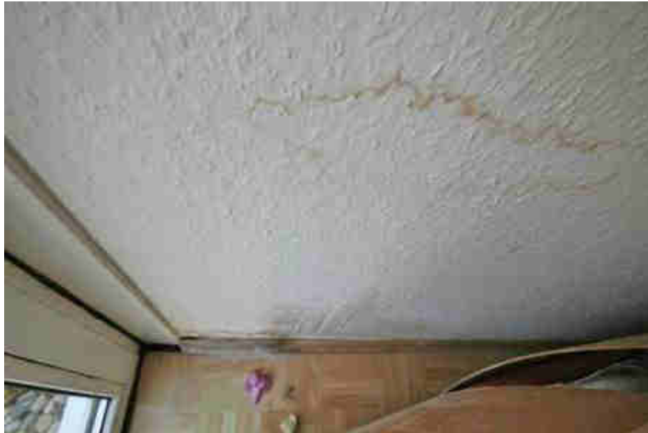
Blick auf Schwarzsimmelbildung an den Dichtungsfugen der Fassadenkonstruktion des Wohnraumerkers im Anschluss an den Deckenoberbelag sowie Feuchtigkeitsflecken im Sockel- und Außenwandbereich
