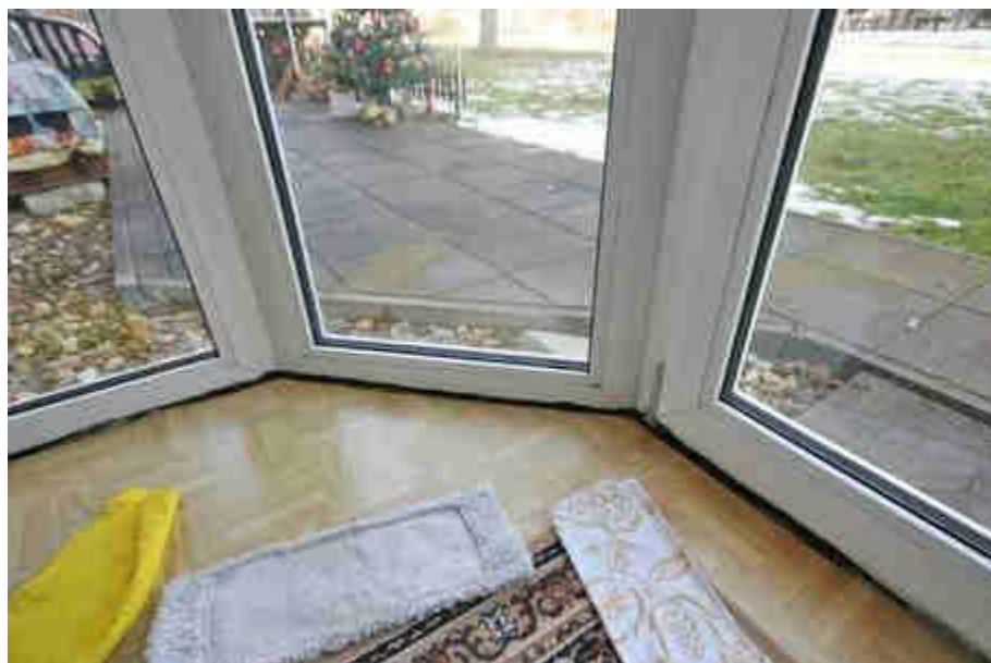
Blick auf Schwarzsimmelbildung an den Dichtungsfugen der Fassadenkonstruktion des Wohnraumerkers im Anschluss an den Deckenoberbelag
