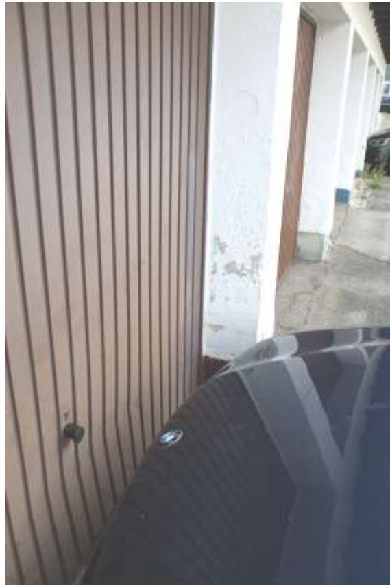
Abb. 8: FINr. 868/19 - Beschädigtes Garagentor, Putz- und Farbschäden
