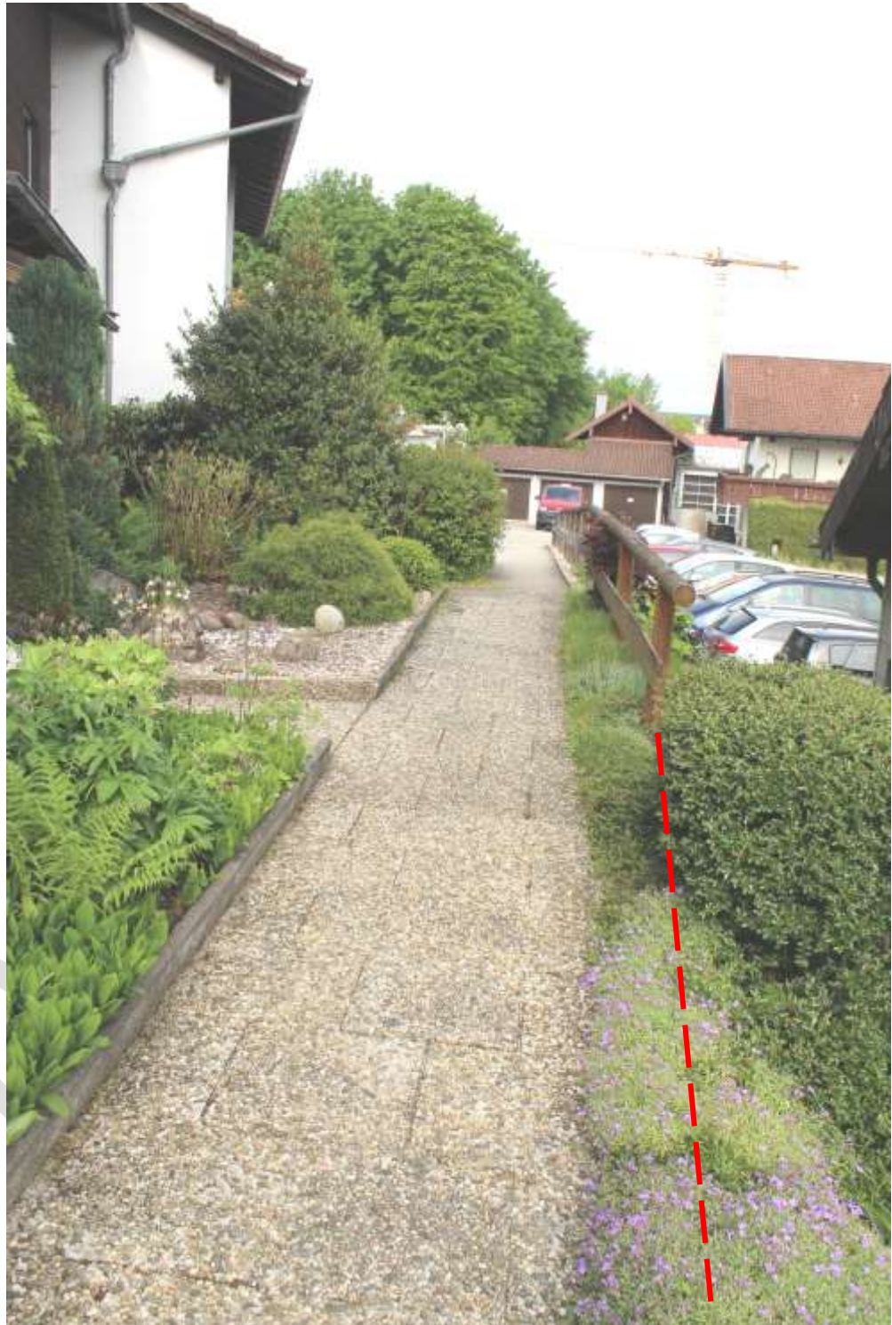
Abb. 4: FlNr. 868/26 – Hoffläche westlicher Bereich, Zugang zu Haus 67e, rote Linie zeigt den Bereich mit unzureichender, fehlender Absturzsicherung
