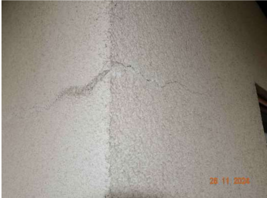
Abbildung 31: Beispiel von Fassadenrissen am Wohnhaus
