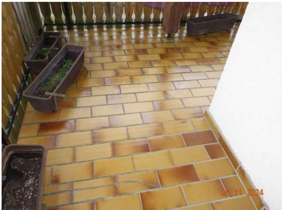
Abbildung 32: Beispiel schadhafter Bodenfliesen am Balkon
