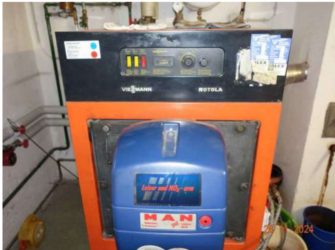
Abbildung 11: Heizkessel und MAN-Brenner
