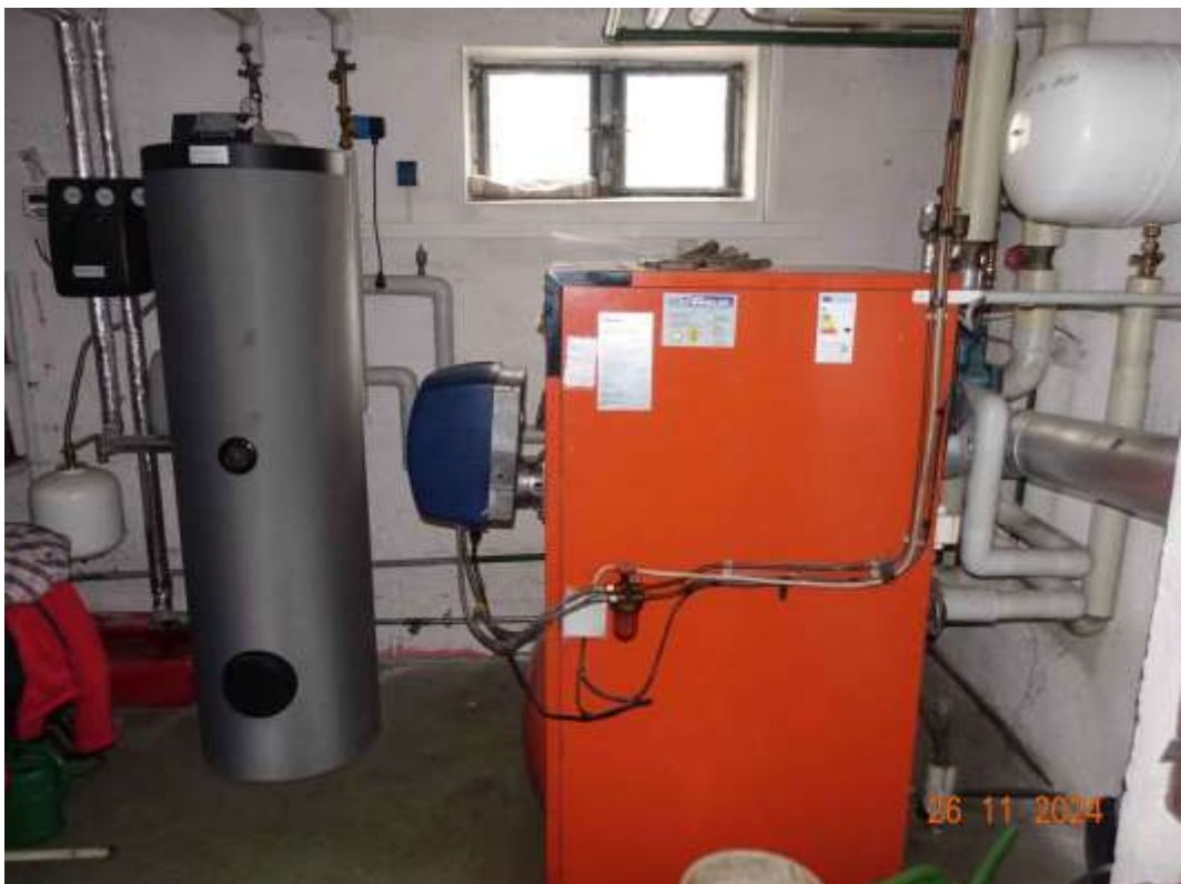
Abbildung 10: Öl-Zentralheizung und Warmwasserbehälter der Solaranlage
