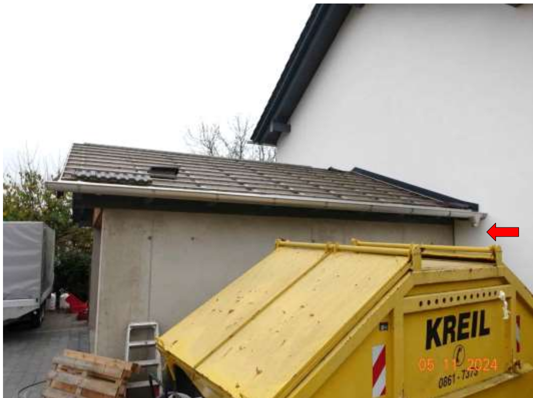
Abbildung 4: Fehlende Dacheindeckung und Dachentwässerung am Tag des Ortstermins
