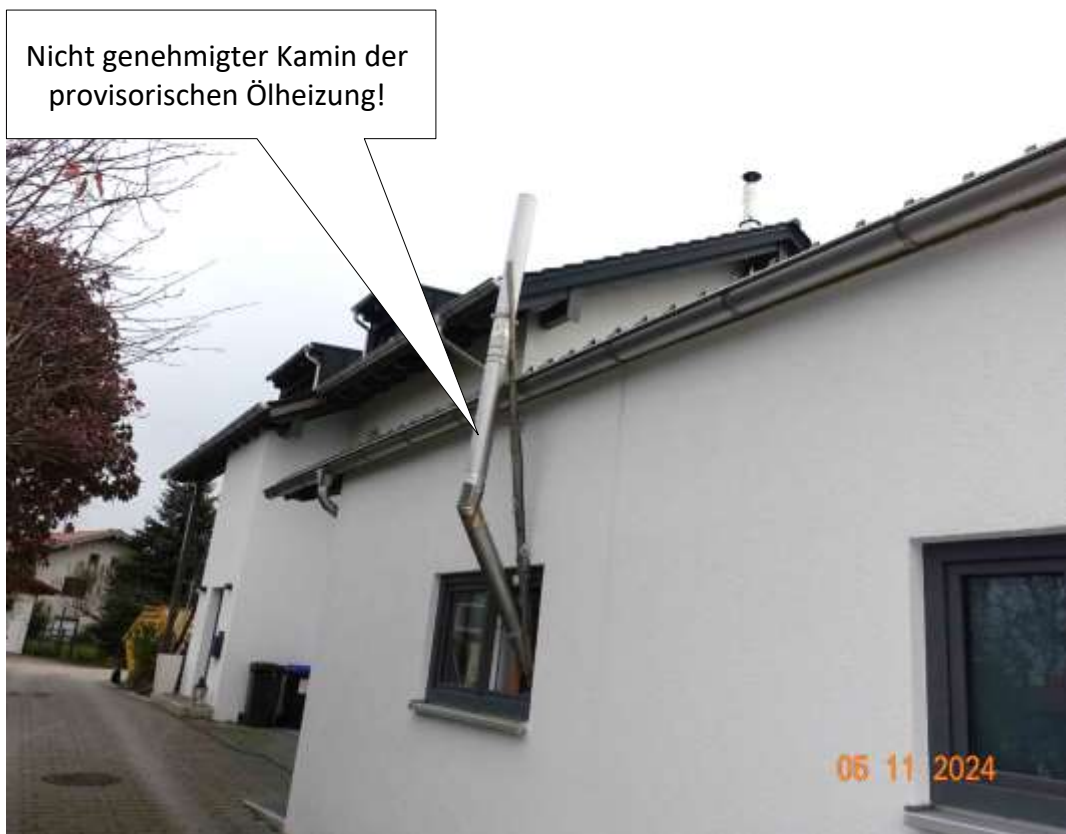
Abbildung 10: Nicht genehmigungsfähiger Kamin im Anbau für die Ölheizung!
