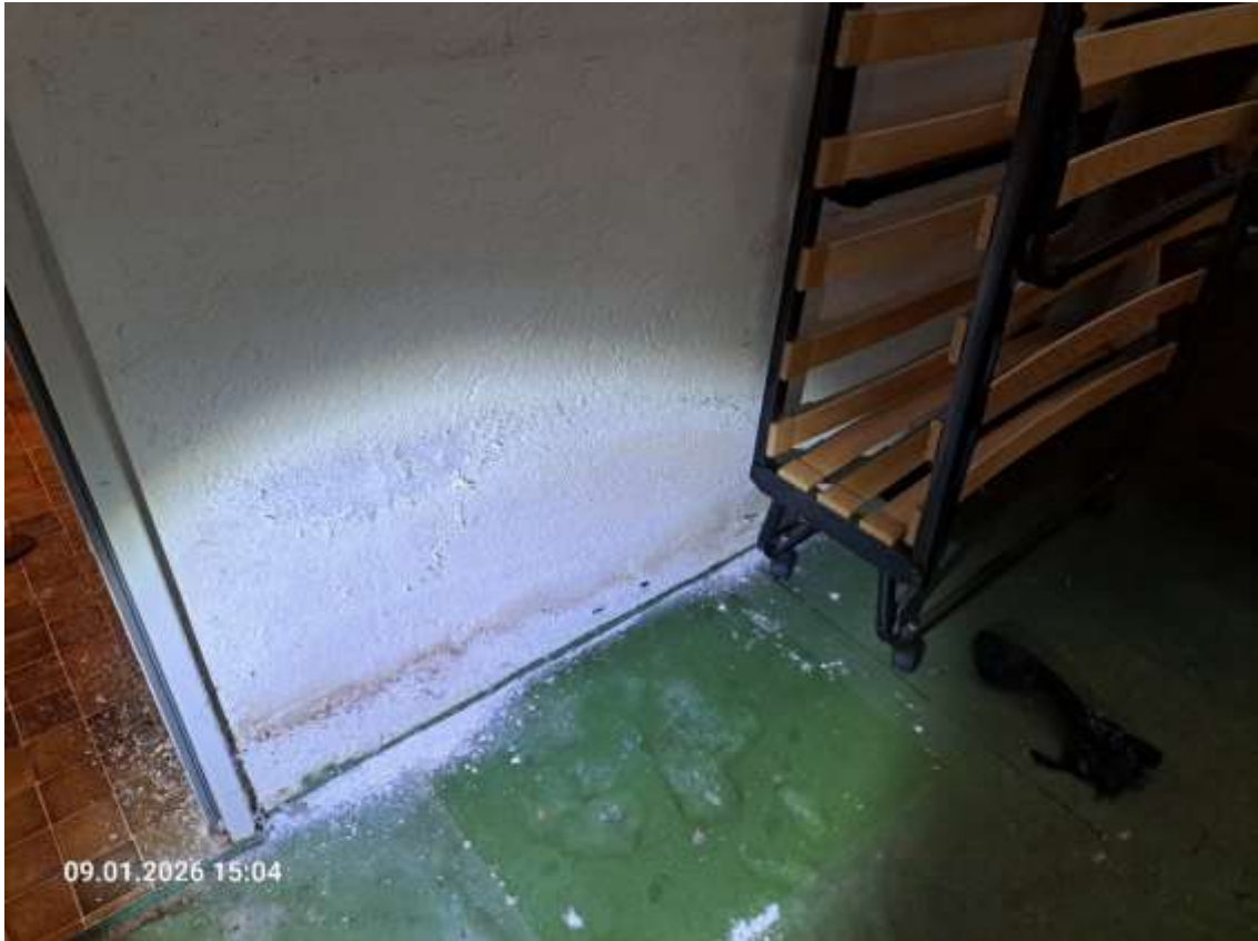
Keller, Innenwand zum Flur, Sockelfeuchte
