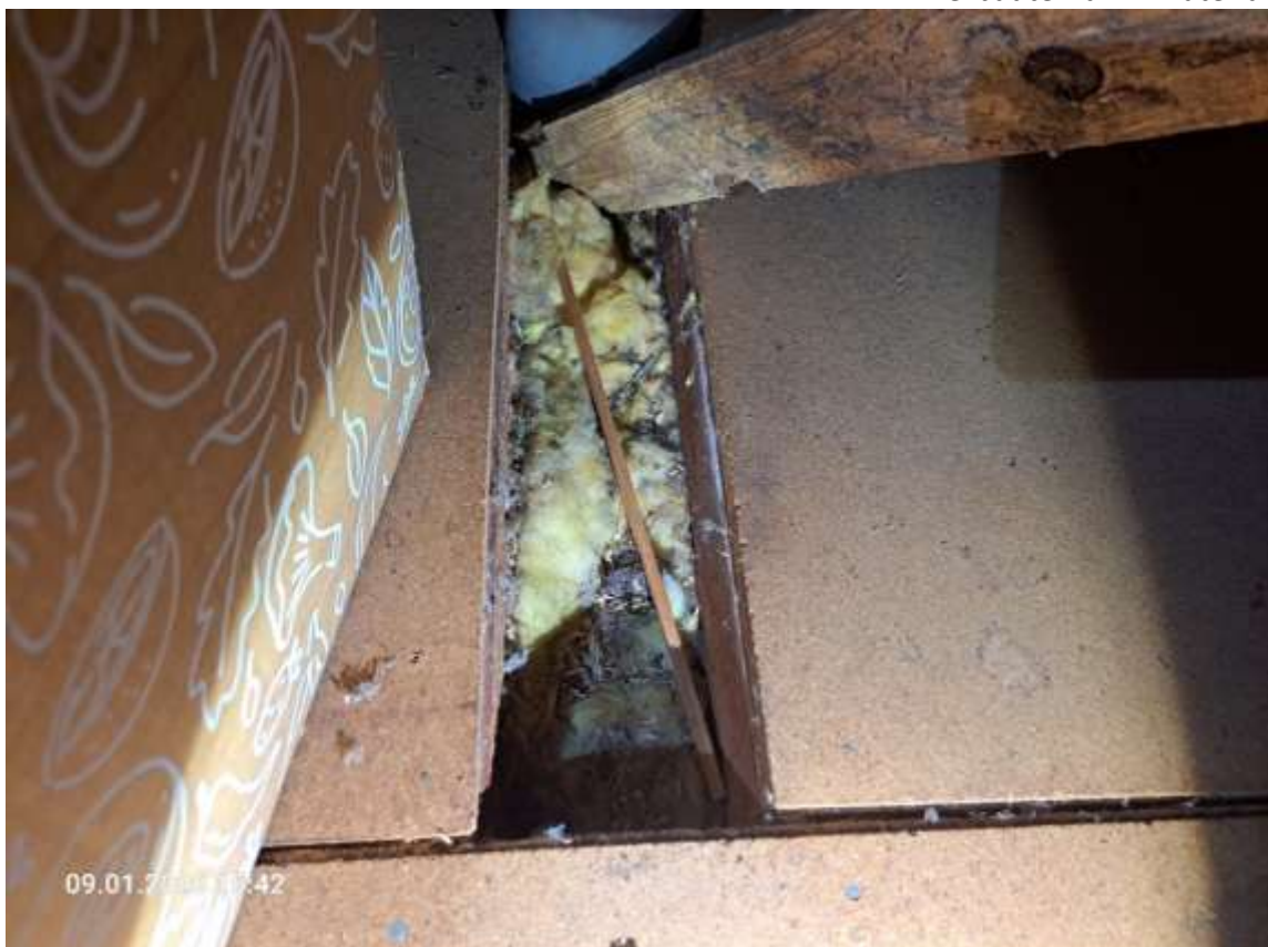
Spitzboden, Bodenbelag, Spannplattenbelag nicht bündig verlegt, offene Stellen, Blick auf das verbaute Dämmmaterial
