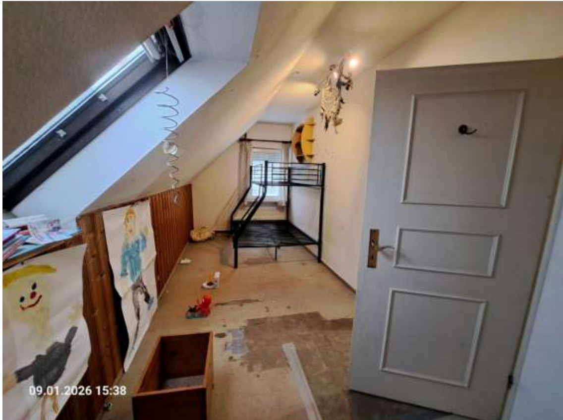
Ausgebautes Dachgeschoss, Kinderzimmer, Nordwestseite, Bodenbelag fehlt beim Eingang
