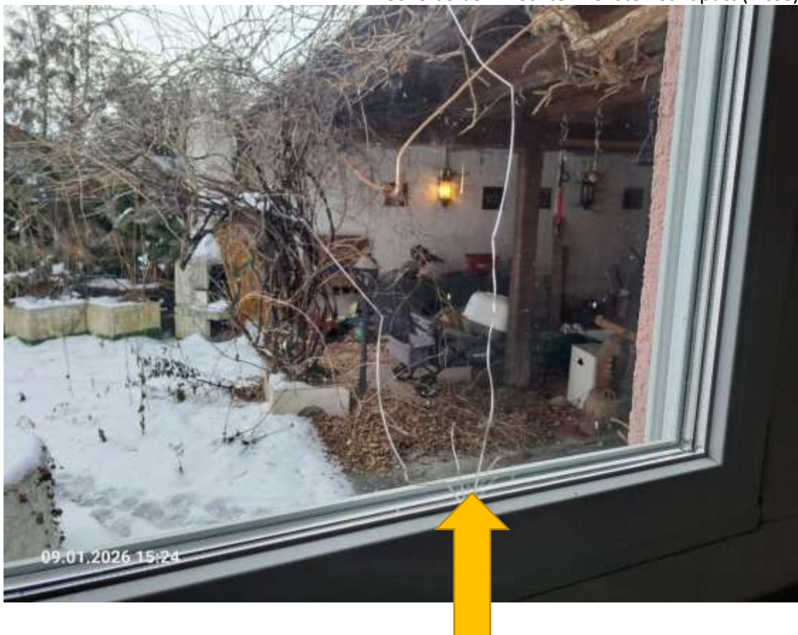
Scheibe beim rechten Fenster ist kaputt (Risse)
