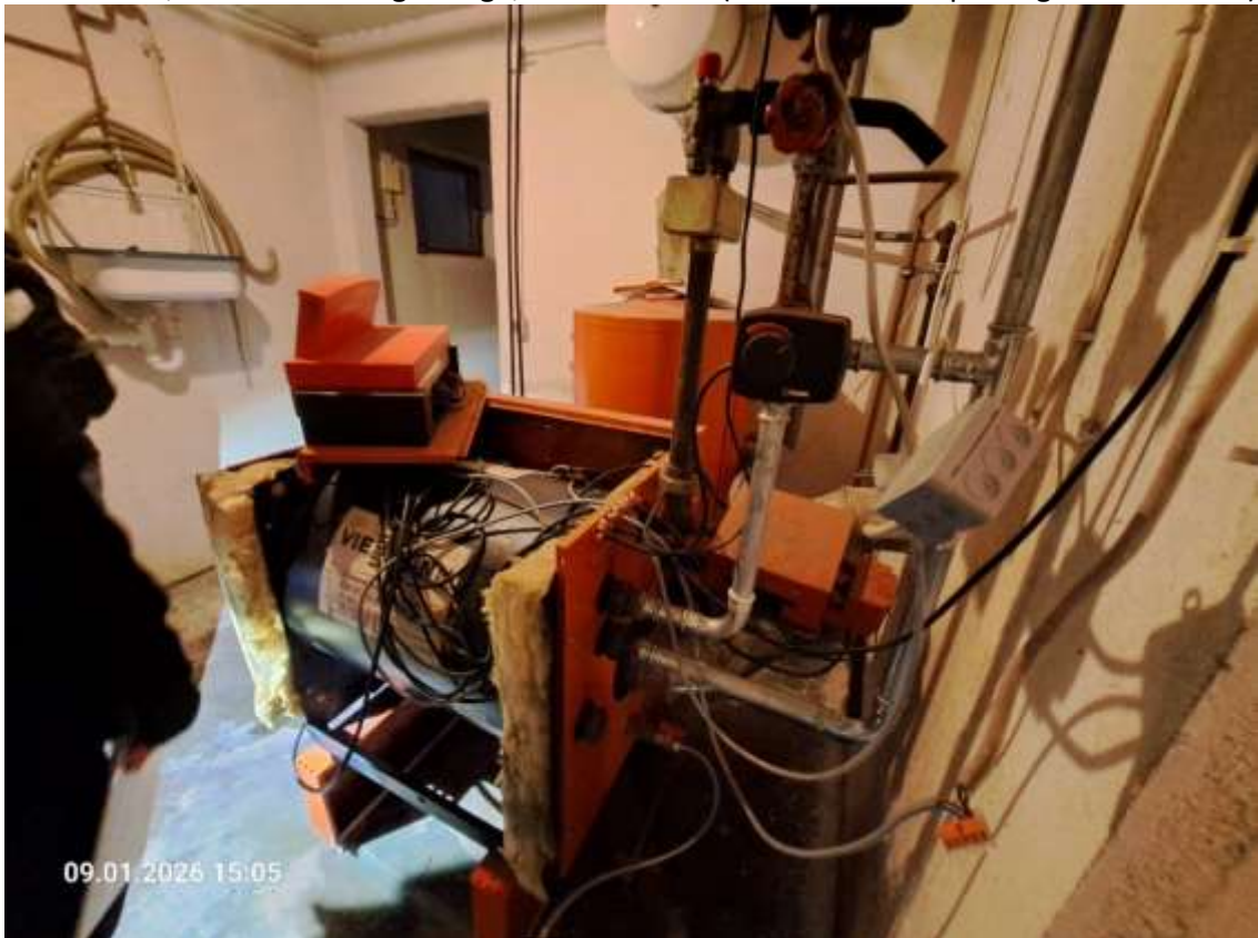
Keller, defekte Heizungsanlage, Kessel defekt (mit Taschenlampe aufgehellter Raum)
