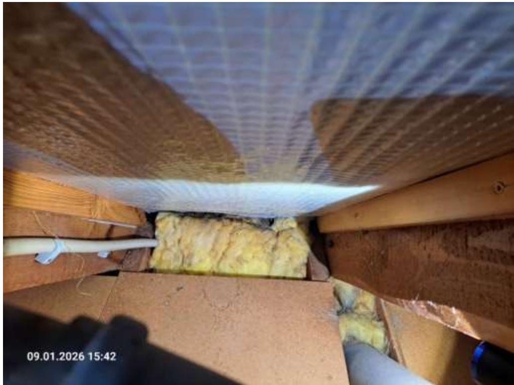
Spitzboden, Bodenbelag, Spannplattenbelag nicht bündig verlegt, offene Stellen, Blick auf das verbaute Dämmmaterial
