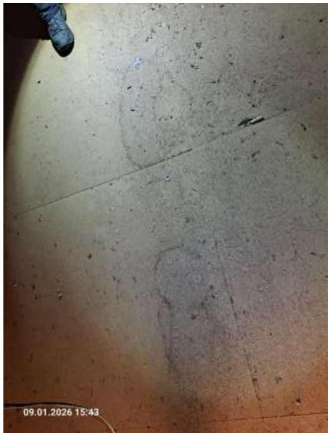
Spitzbodenbereich, Bodenbelag, teils abgetrocknete Wasserflecke, Hinweis auf vormalige Leckagen
