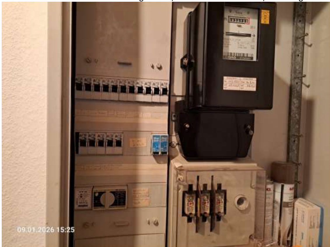
Erdgeschoss, Flur bei der Garderobe, Sicherungskasten
