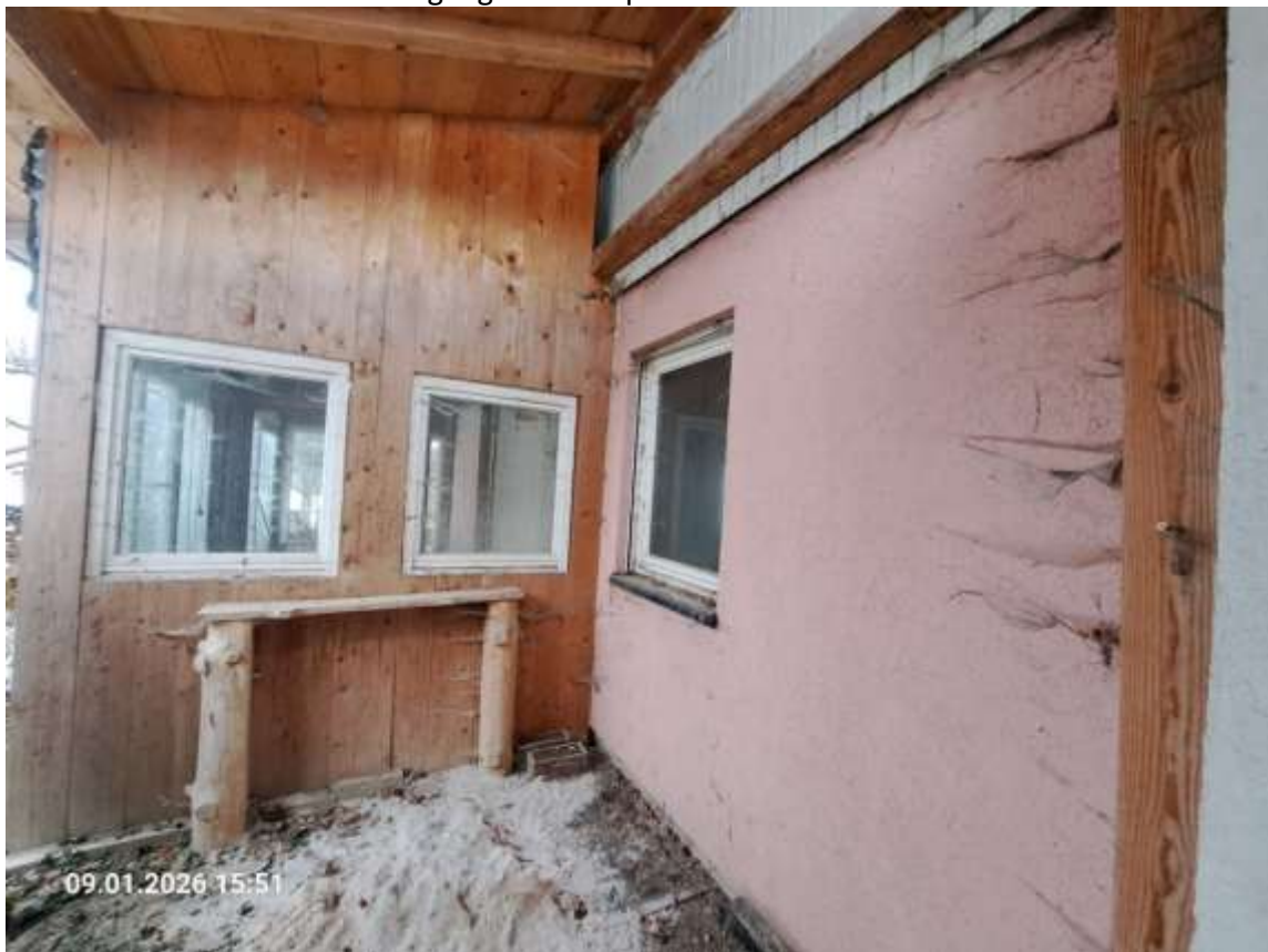
Nordfassade vom Wohnhaus m. angebautem Hühnerstall in Holzbauweise, Zugang beim Carport Nordseite über die Geräte Abstellkammer
