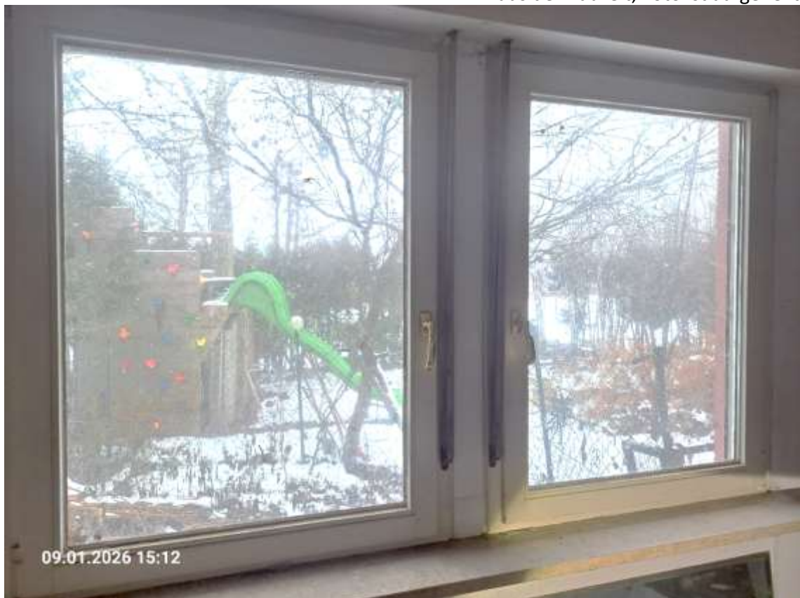
Erdgeschoss, Fenster nach Osten, Beispiel f. Qualität der Fenster im Wohnhaus, EG und DG, aus der Bauzeit, Foto ist aufgehellt
