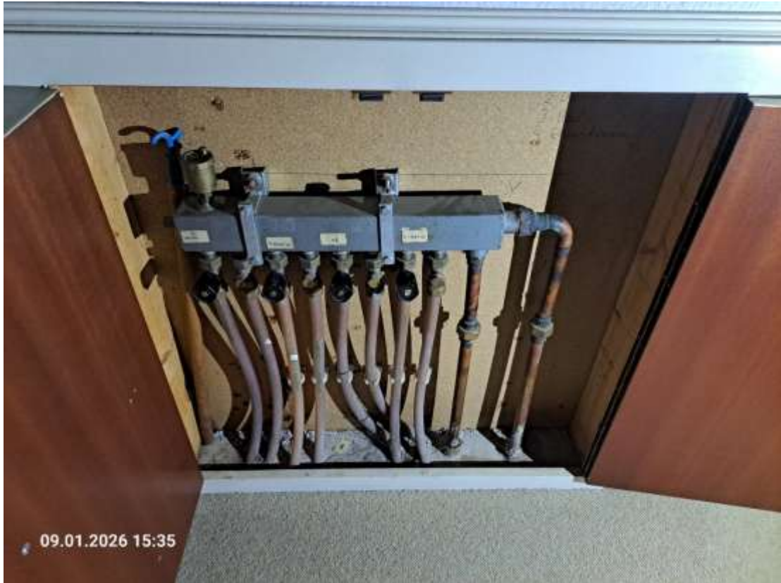
Ausgebautes Dachgeschoss, Flur, Fußbodenheizung, Verteiler im Kasten
