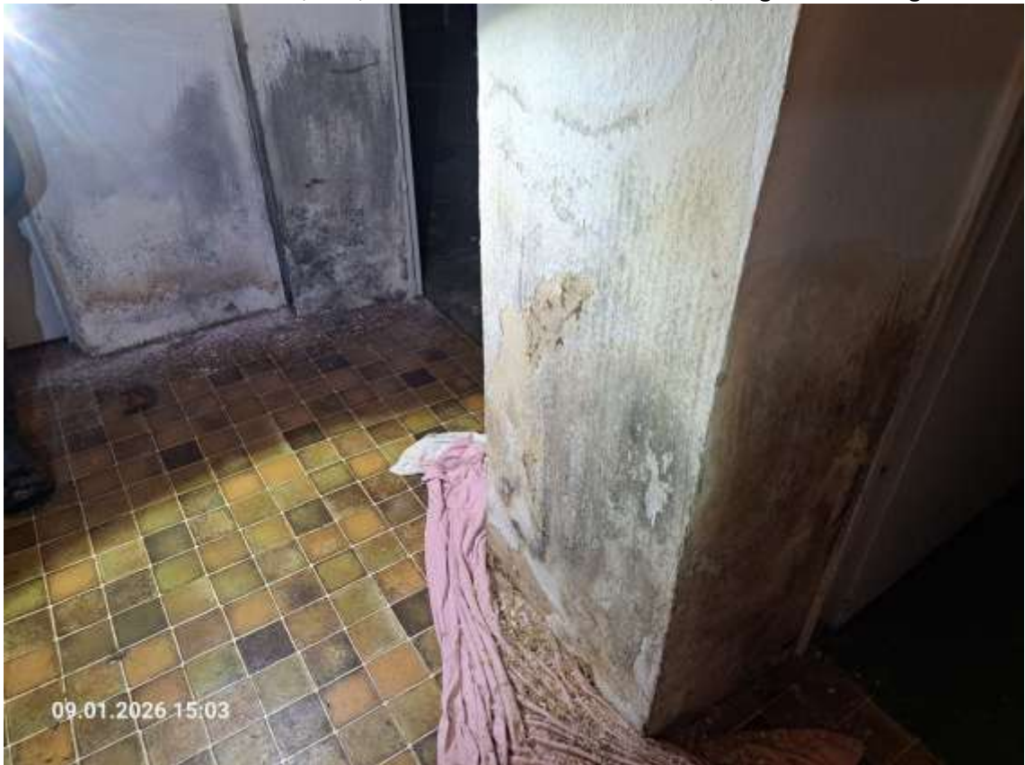
Keller, Flur, Schäden an den Innenwänden, aufgrund Heizungsschaden
