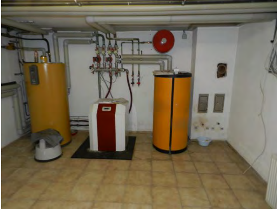
Heizungsraum, KG, Gemeinschaftseigentum
