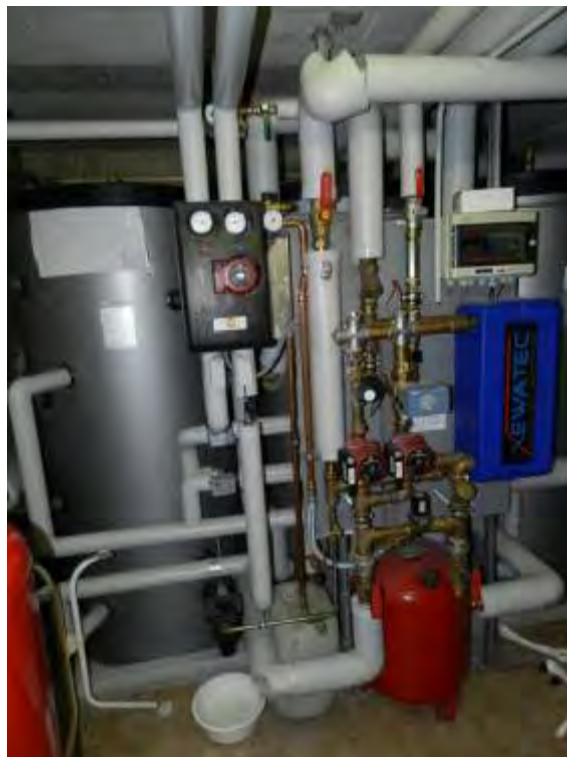
Gartenstr. 3, Übergabe Fernwärme, KG
