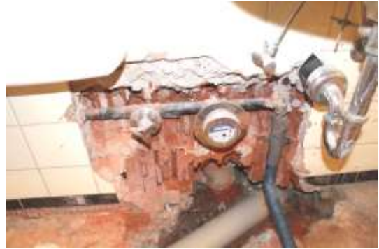
Abb. 13b: Bad – Wasserzähler
