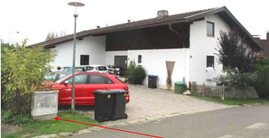
Abb. 3: Nordostansicht, gemeinschaftl. Kfz-Stellplätze, Strom verteilerkasten
