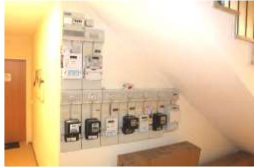
Abb. 18: Stromzähler unter UG-Treppe
