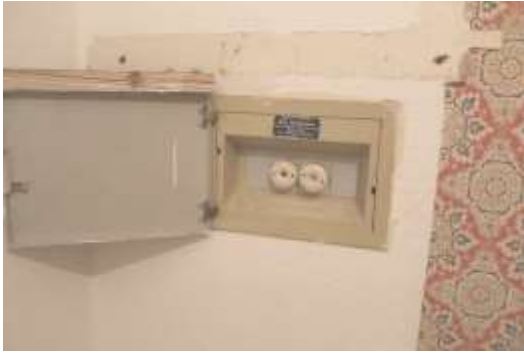
Abb. 12: Sicherungskasten der Wohnung
