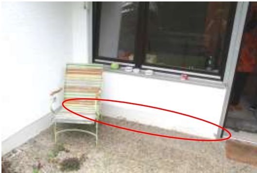
Abb. 16a: Feuchtigkeitsschäden Sockel
