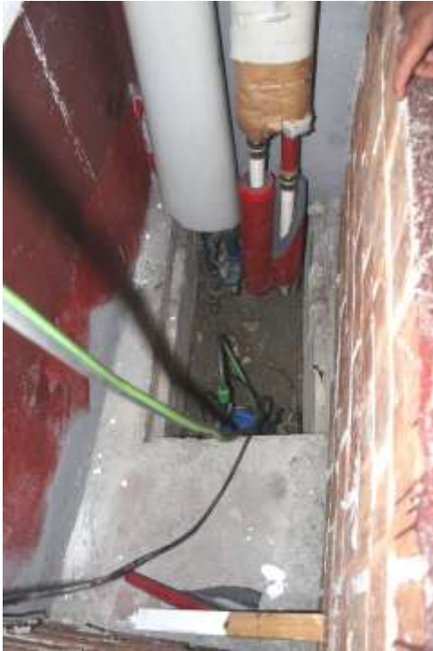
Abb. 21: Offener Bodenschacht mit Pumpe im Keller
