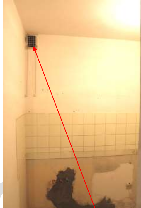
Abb. 15: Küche, mechan. Entlüftung
