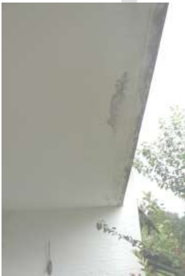
Abb. 17: Feuchtigkeitsschäden Balkonuntersicht – Terrasse Whg.-Nr. 2
