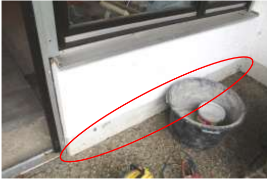
Abb. 16: Feuchtigkeitsschäden Sockel Terrasse Whg.-Nr. 2
