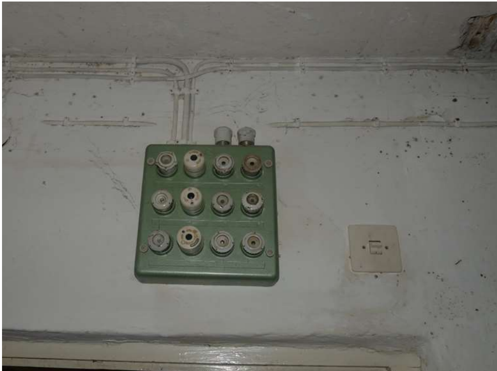
Bild 38: Sicherungen im EG
