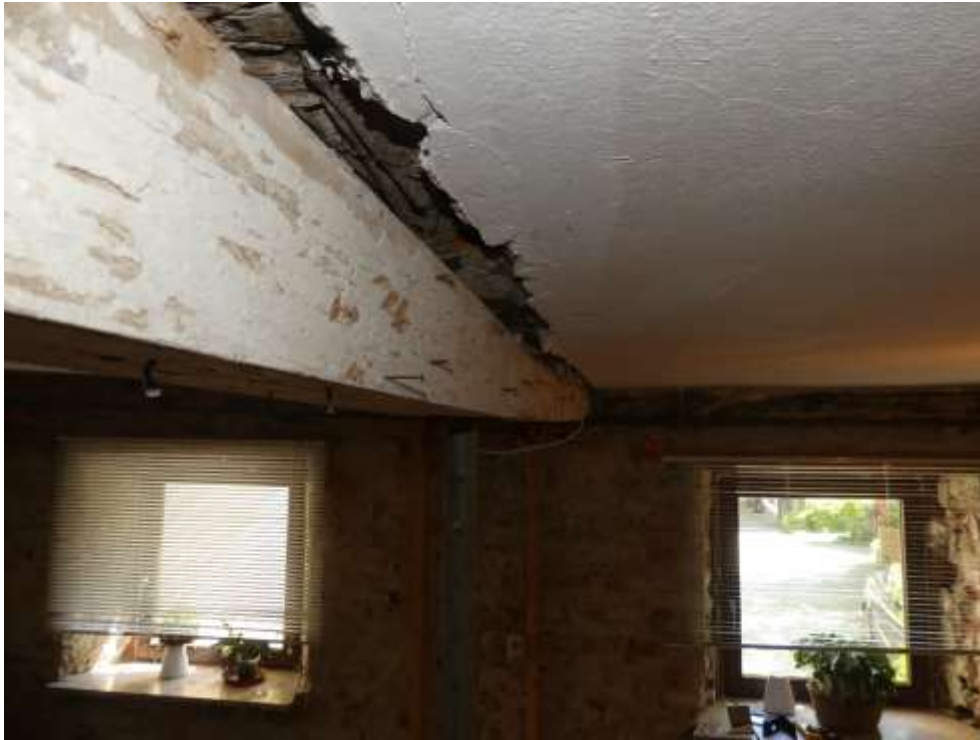
Bild 19: Holzbalken mit deutlichem Durchhang
