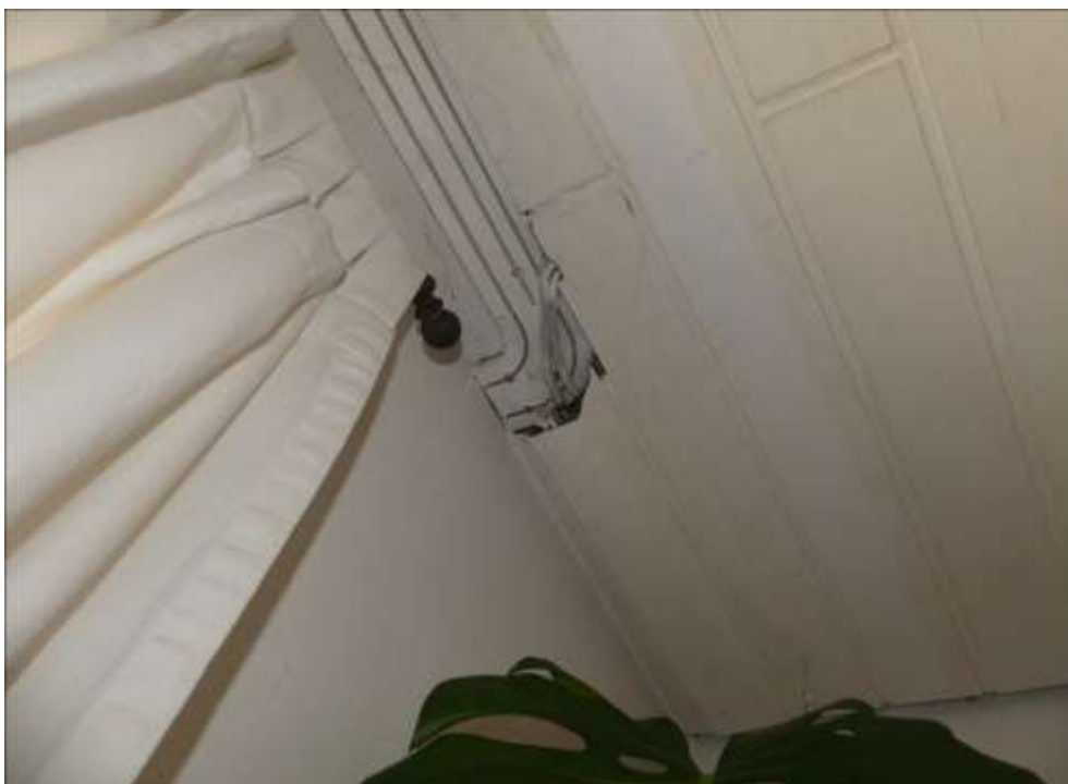
Bild 28: Elektrokabel OG Mitte
