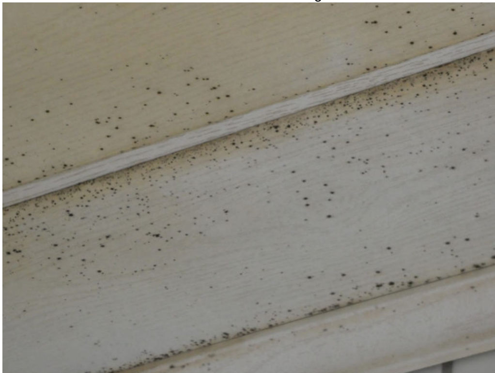
Bild 9: Schimmelflecken an der Deckenverkleidung im Bad
