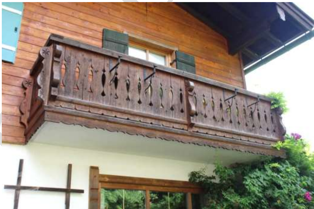
Abb. 12b: Zustand Holzteile, Hagelschaden - Westbalkon
