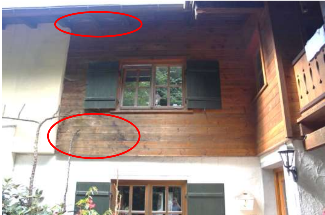
Abb. 9: Zustand Holzschalung Nordseite, Wasserspuren Vordach
