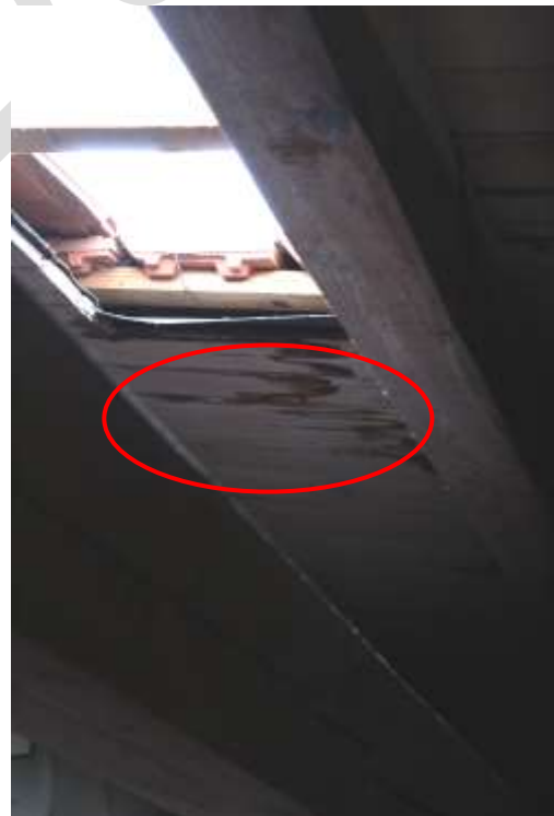
Abb. 11c: Speicher – Feuchtigkeitsflecken, Bereich um Glasschindel
