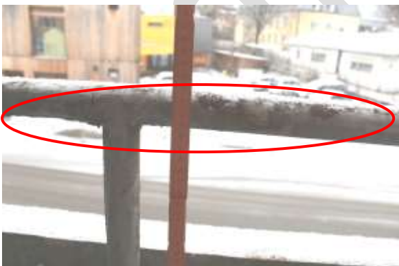
Abb. 10b: Roststellen Geländer - beispielhaft
