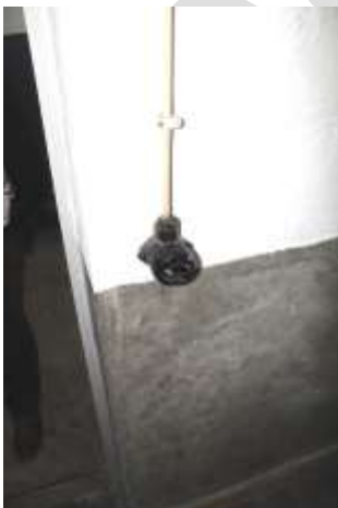
Abb. 16: Keller - alte Lichtschalter (beispielhaft)
