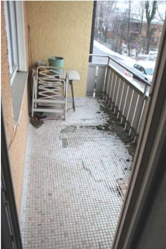
Abb. 10a: Loggia Whg. Nr.3 – schadhafter Belag
