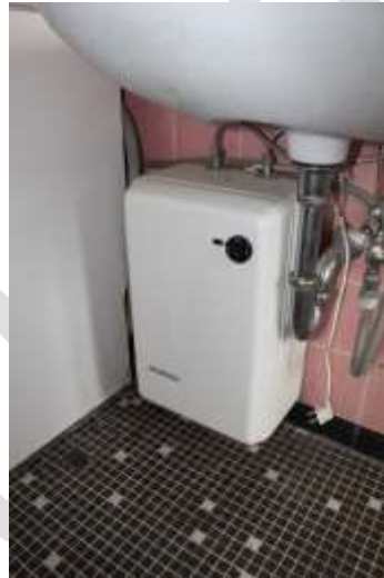
Abb. 8c: Bad, Elektr. Boiler unter Waschbecken
