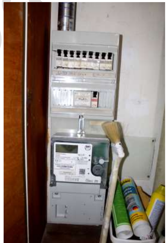
Abb. 7: Sicherungskasten Whg. Nr. 3
