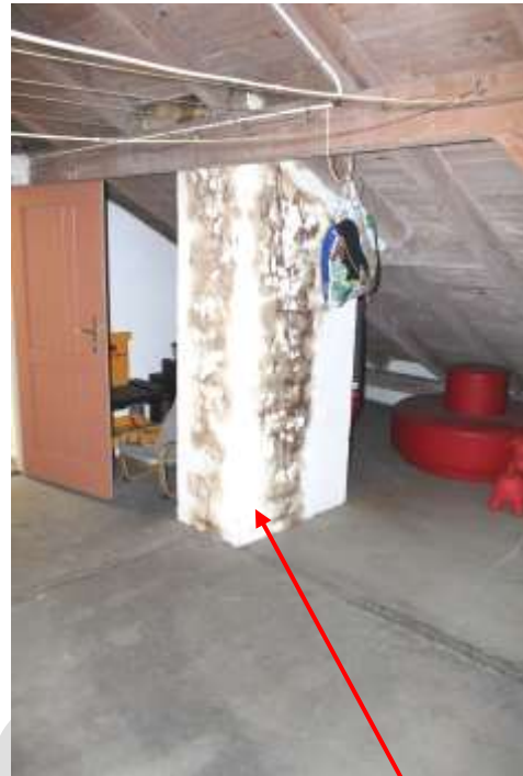
Abb. 11b: Speicher – versotteter Kamin
