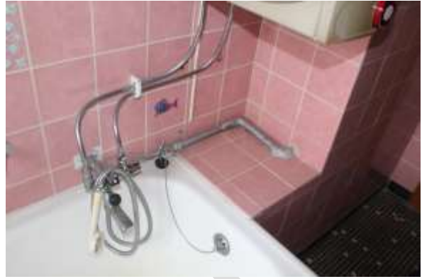
Abb. 8b: Bad, Kaltwasserzufuhr auf Putz
