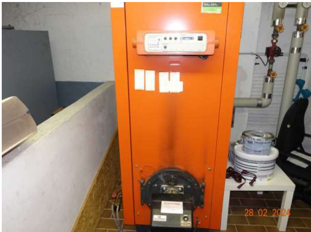
Abbildung 24: Heizkessel von Viessmann
