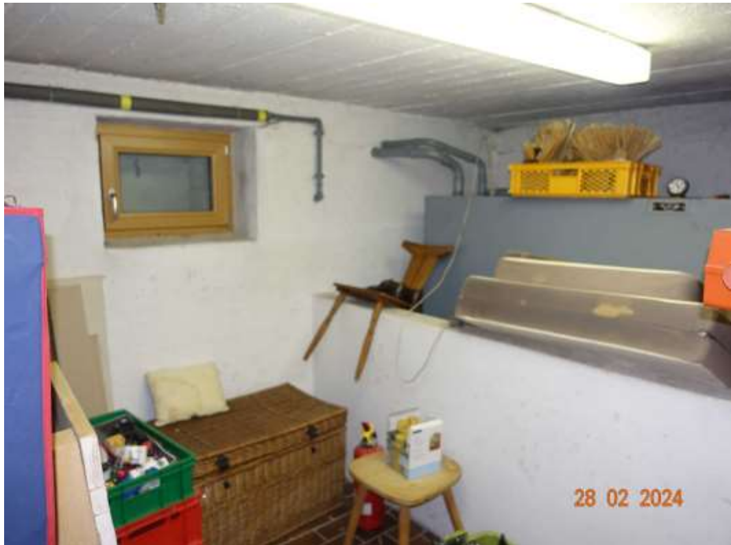
Abbildung 23: Keller mit Stahltank für Heizöl
