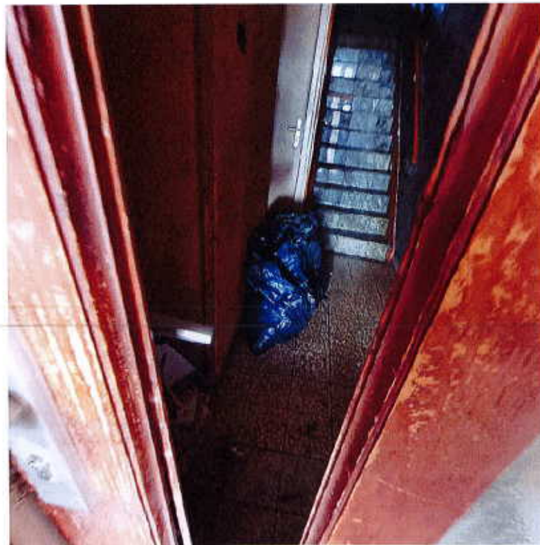
Ansicht aufgebrochene Hauseingangstüre
