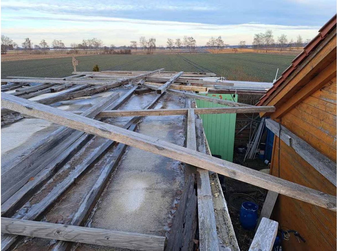
11 Garagendach ohne fertiggestellte Dachabdichtung
