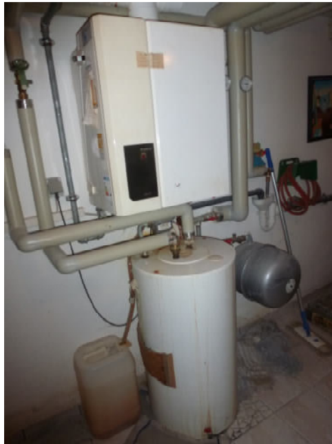
Heizung im KG
