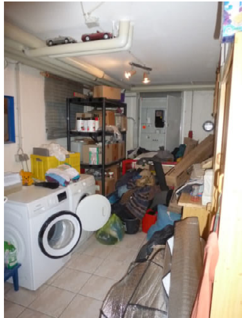
Heizung/Waschraum im KG
