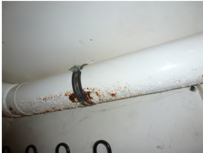
Korrosion Abgasrohr Heizung
