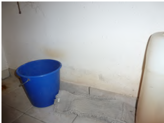
Feuchtigkeitsschäden im Heizungs-/ Waschraum
