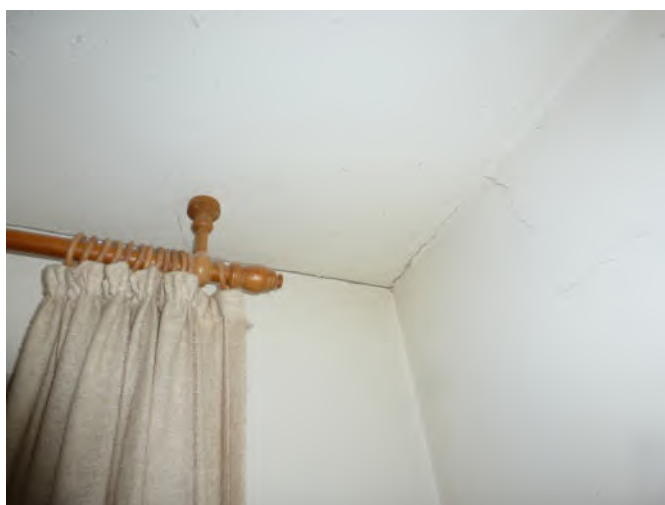
Rissbildungen im Flur im OG
