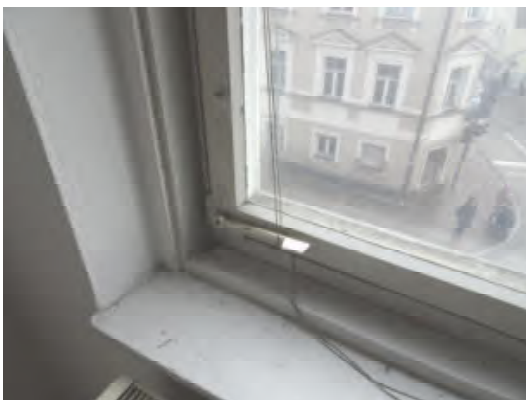
abgewittertes Fenster DG
