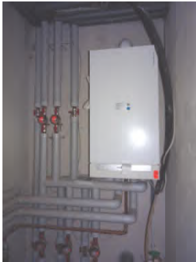
Heizungsanlage im EG
