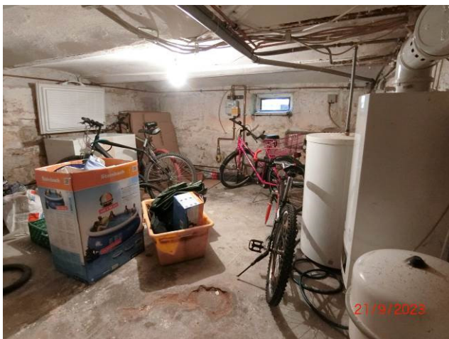
Heizungs-/Hautechnik-/Abstellraum im Kellergeschoss
