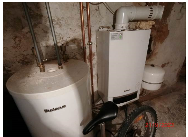
Heizungsanlage im Kellergeschoss
