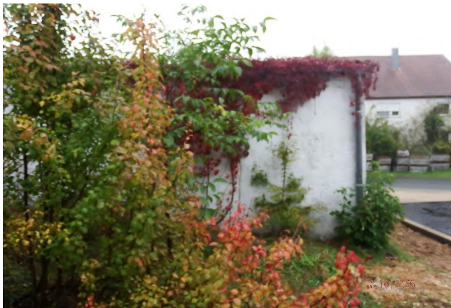
Außenputz und Regenrinne aus Zink mit rückwärtigem Grundstücksbereich, ausschließlich begehbar über das Nachbargrundstück FINr. 635
